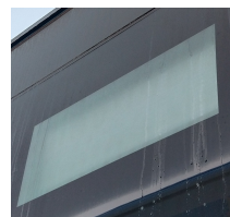
Condición inaceptable de empañamiento de ruterros
