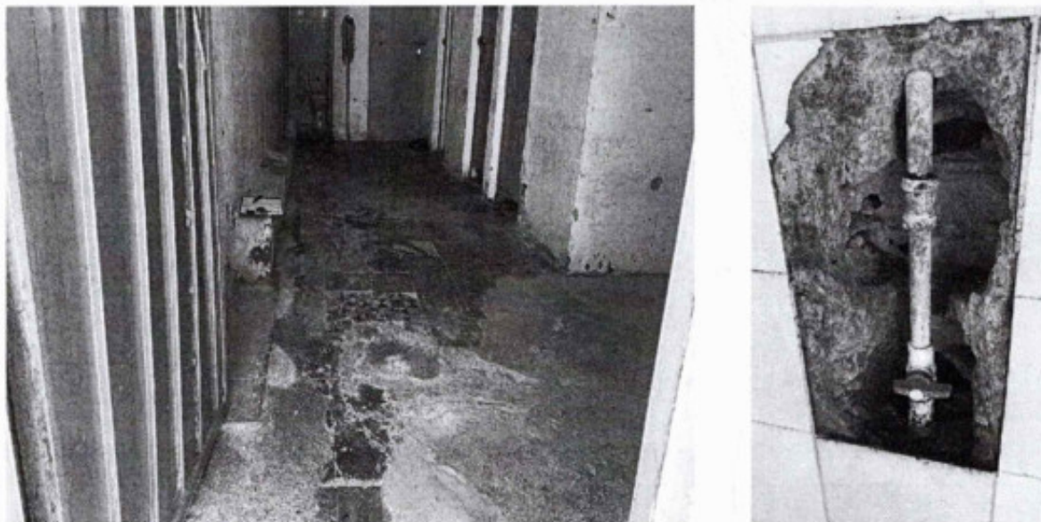
Foto 10. Deterioro en pisos, estación de policía cabecera municipal.
