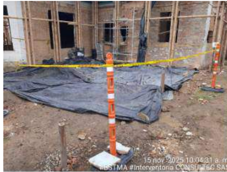
Señalización de áreas
