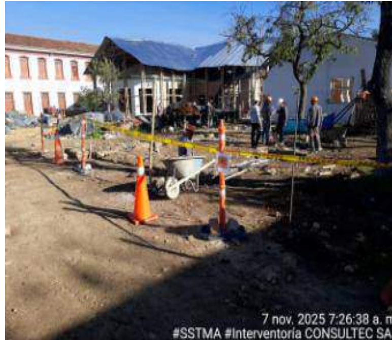
Señalización de áreas
