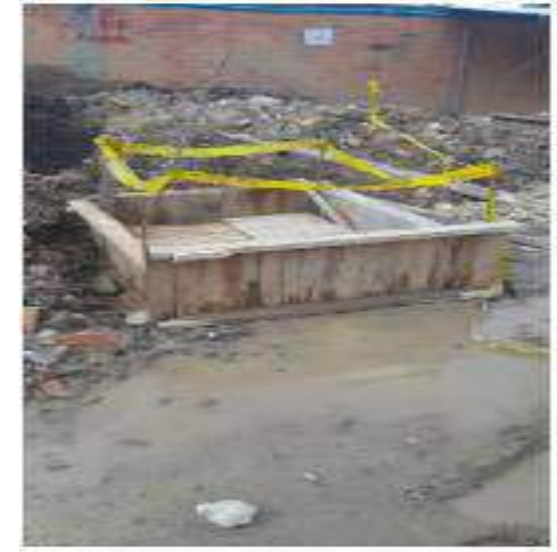
Señalización de áreas
