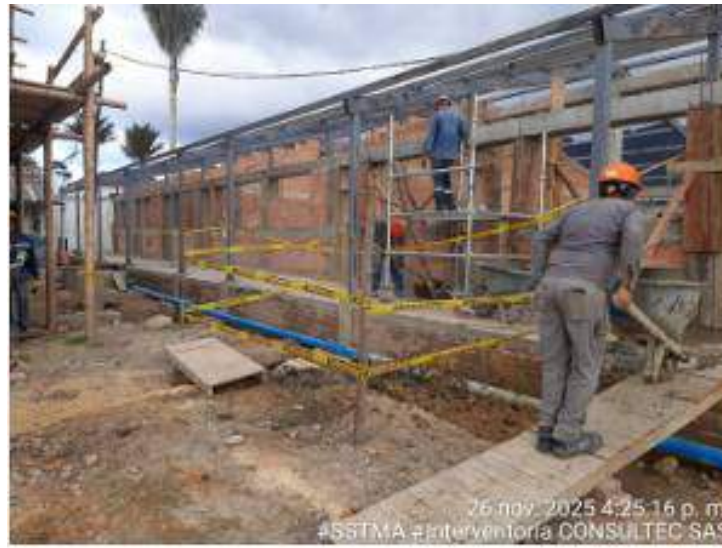
Señalización de áreas
