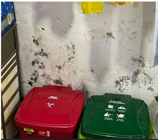
Humedad por capilaridad en muros de consultorios, afectando con hongos y esporas de moho los implementos y demás materiales allí implementados que afectan la salubridad del ambiente y consultorio.
