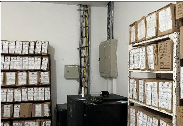
Área de archivo general afectada por filtraciones de agua desde la cubierta
