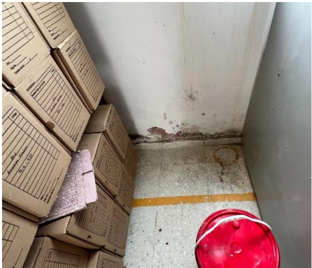
Humedad por capilaridad en muro en archivo, afectando estantería, carpetas y demás documentos que allí reposan
