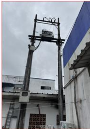
Transformador 112.5 KVA en estructura tipo H.
