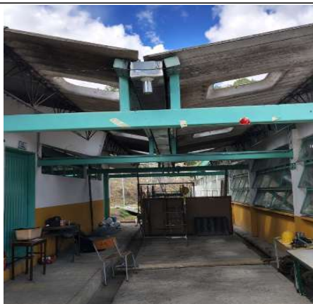
FOTO No 3 CAMBIO DE CANAL EN AULA MÁXIMA IE MALHABAR SEDE B - FRANCISCO GIRALDO
