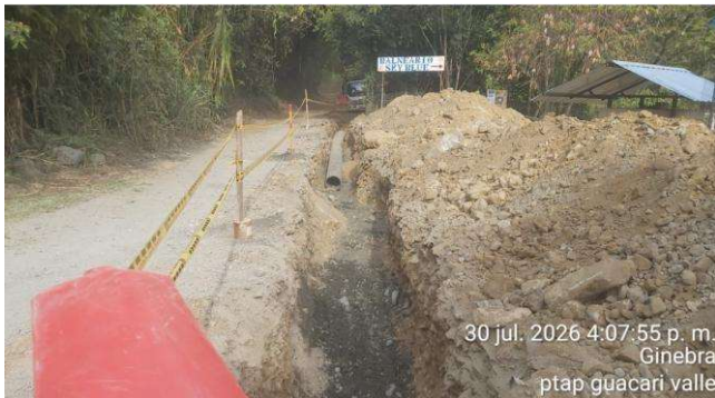
Señalización y demarcación de excavaciones sobre la vía.
