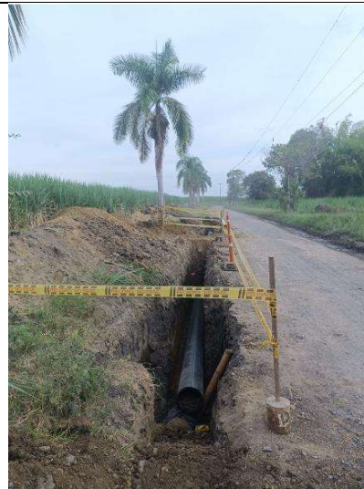
Señalización y demarcación de áreas de alto riesgo.
