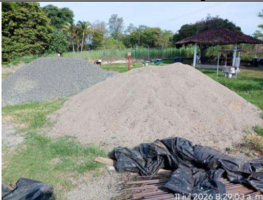
Área de acopio de arena PTAP - Ginebra
