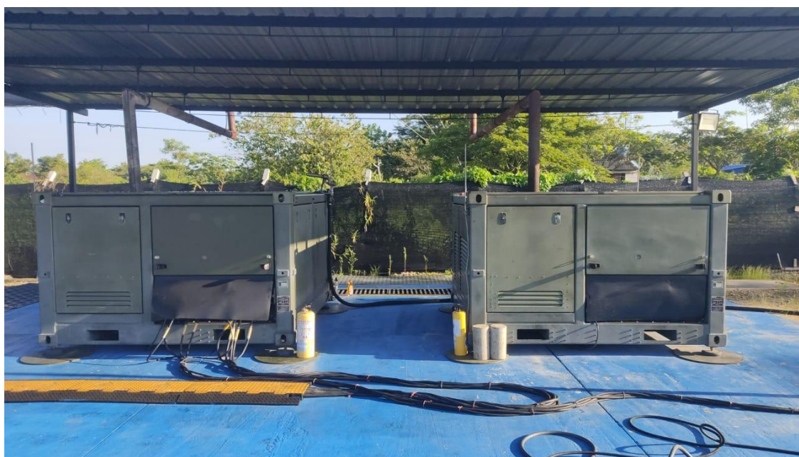
Vista del panel de control y panel de conexiones.
