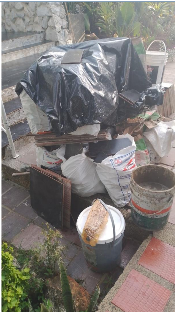
Figura 24. Protección temporal de residuos y materiales frente a la intemperie.
