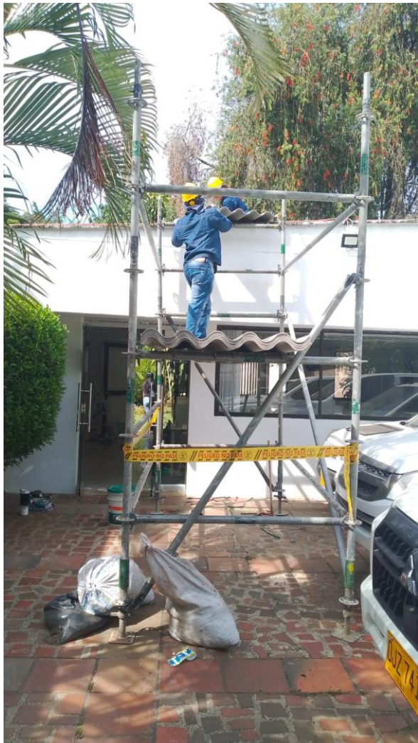
Figura 36. Delimitación preventiva del andamio.
