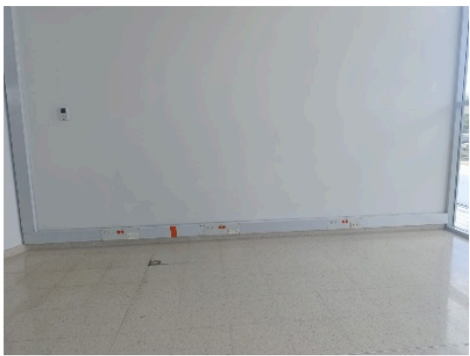
Sistema de cableado estructurado Corriente normal y regulada
