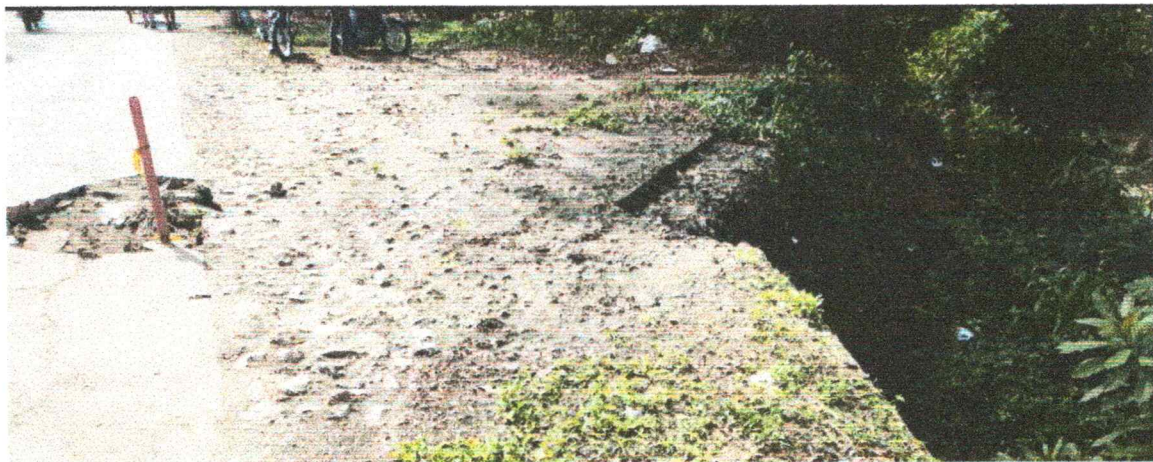
Fotografía 8. Hundimiento de losas de pavimento en zona posterior a aletas y muro de gaviones.
