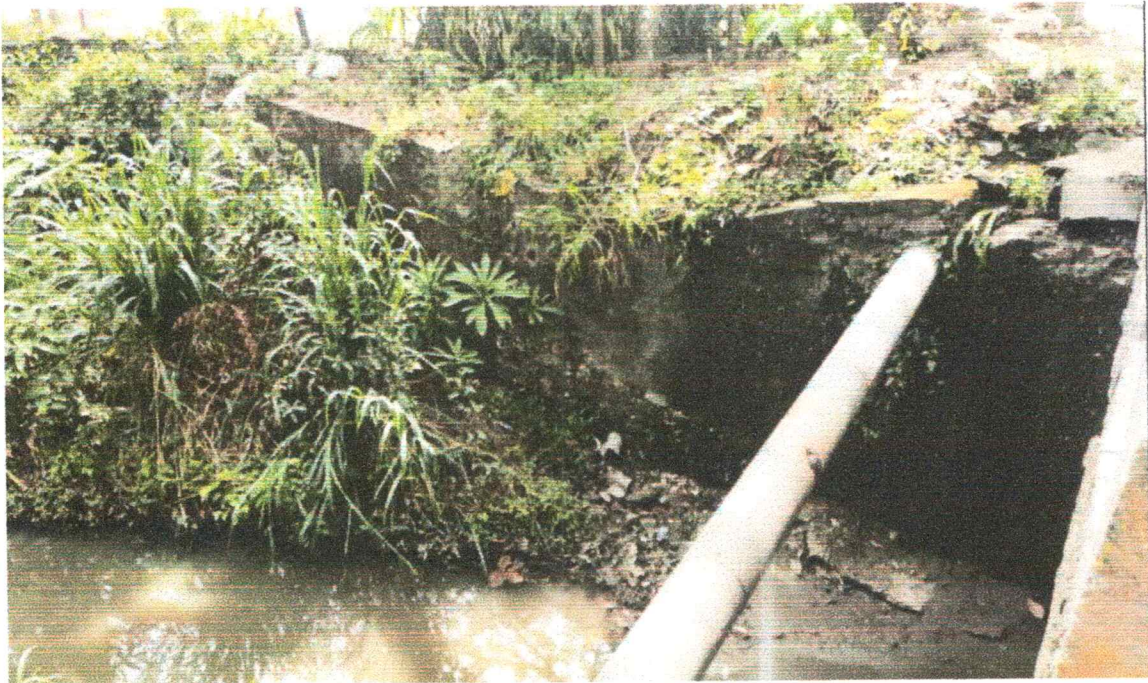
Fotografía 3. Estado aleta izquierda en zona de entrada.
