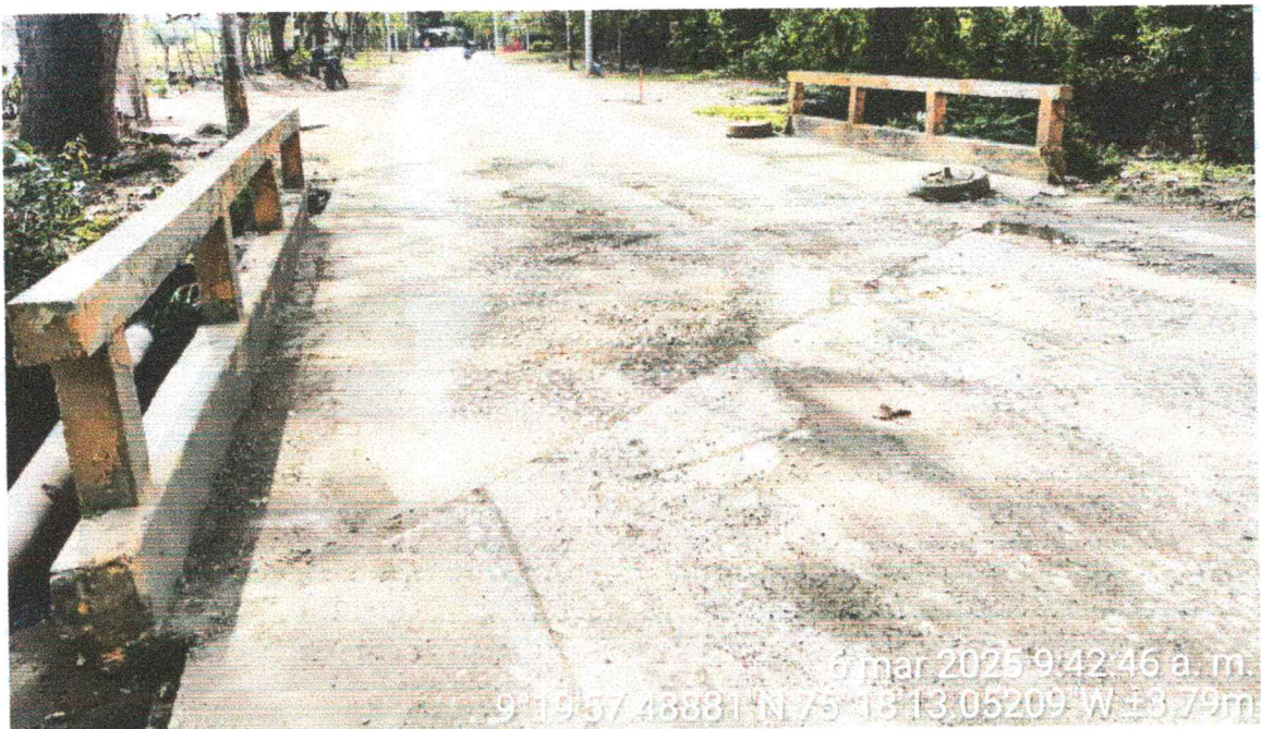
Fotografía 4. Estado zona de paso de la obra. Se evidencia hundimiento de las losas y existencia de dos aberturas en la losa, cubiertas con dos ruedas llenas de concreto.
