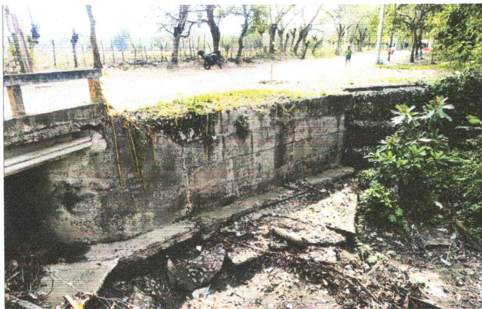
Fotografía 6. Aleta Izquierda zona de salida, se presenta alta socavación de losa en piedra pegada.
