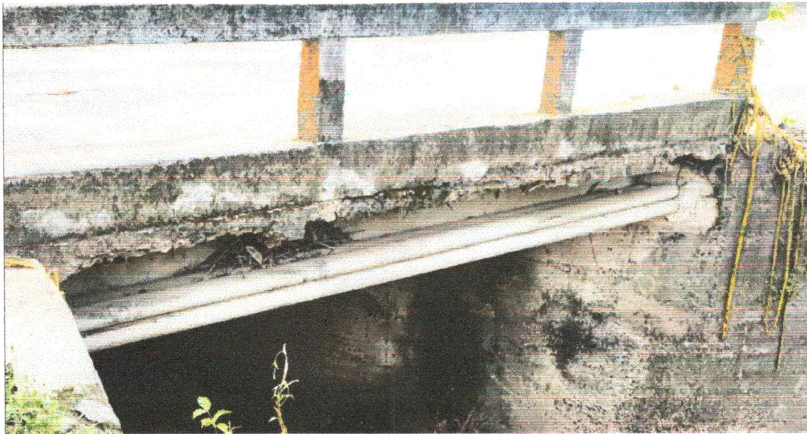
Fotografía 7. Desmoronamiento del concreto de la losa en la zona de salida.
