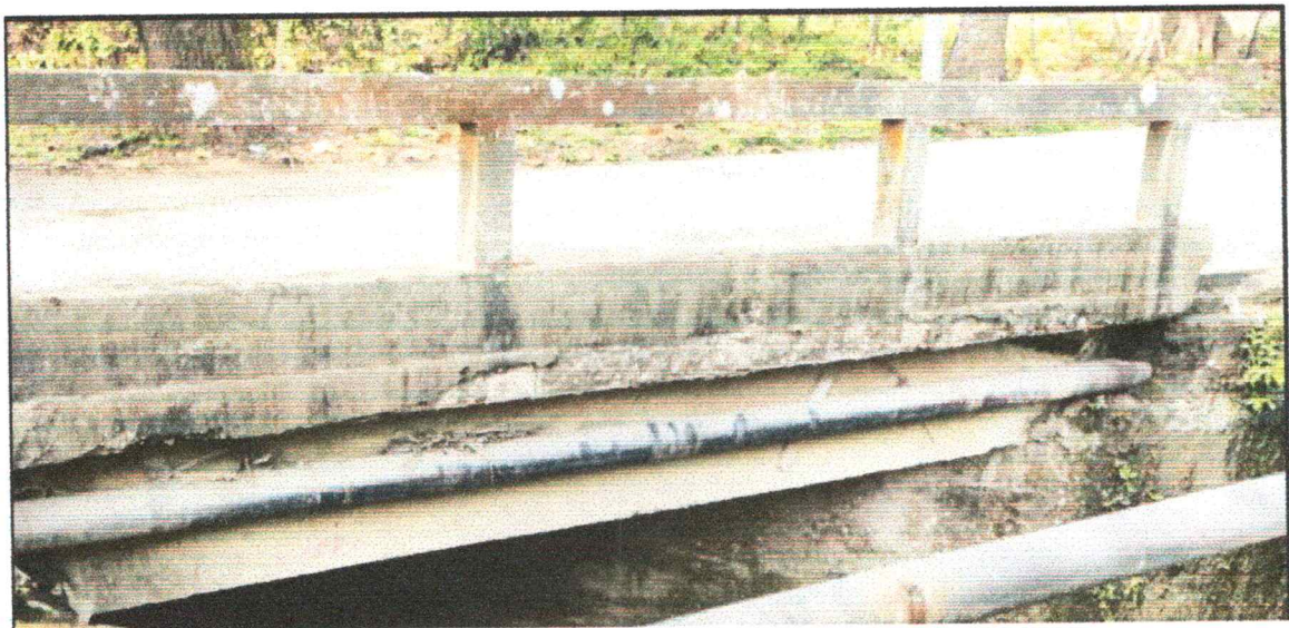
Fotografía 2. Desprendimiento y acero expuesto en losa zona de entrada.
