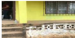
Fotografía N° 2. Muro Exterior de Vivienda en mal estado
