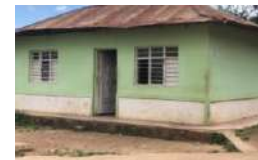
Fotografía N° 3. Vivienda con esportillamiento en filos de andenes
