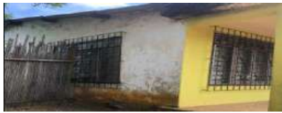
Fotografía N° 1. Caracterización de las viviendas aledañas a la vía - Casa con fisura en muros externos
