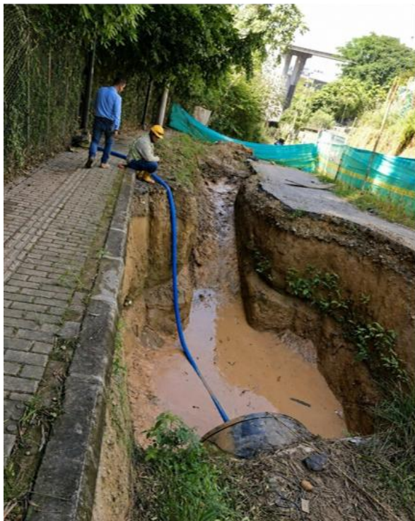
Registro Fotográfico No.11 Causales de Lluvias
