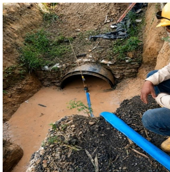
Registro Fotográfico No.14 Causales de Lluvias
