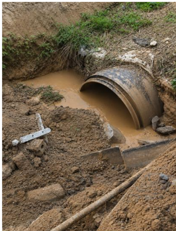
Registro Fotográfico No.12 Causales de Lluvias
