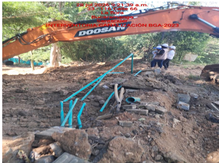
Registro Fotográfico No.3- Redes eléctricas Existente cra 36 (28-31 de julio-2026)
