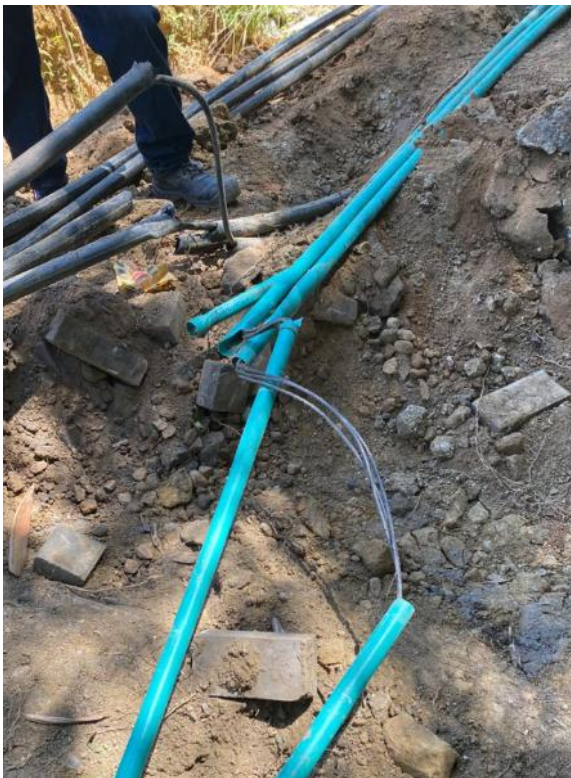
Registro Fotográfico No.1 Redes Eléctricas
