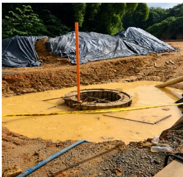
Registro Fotográfico No.13 Causales de Lluvias
