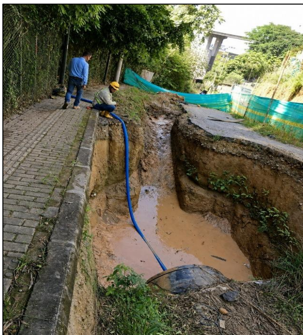
Registro Fotográfico No.11 Causales de Lluvias
