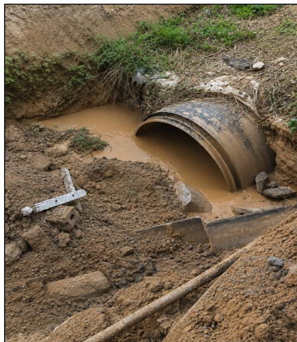
Registro Fotográfico No.12 Causales de Lluvias
