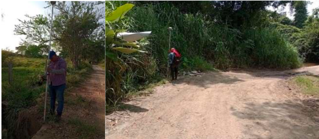
Figura 2. Estado actual de la superficie de rodadura en las abscisas K3+430 y K5+110.
