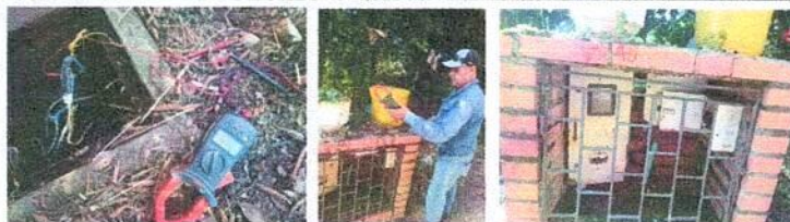
Imágenes 3, 4 y 5: Visita con técnico de la secretaria, para verificar el estado del fluido eléctrico de la cancha múltiple.
