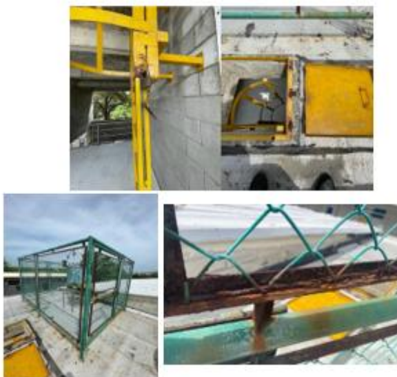
Fig1. Estación IED Juan mina
