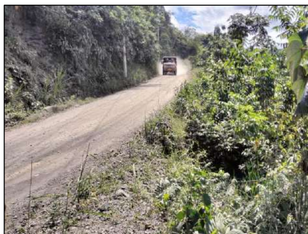
Foto 4. K0+450 – K0+350. Sitio crítico No. 8 – Muro de contención.
