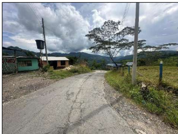
Foto 9. K1+300. Pavimento deteriorado.
