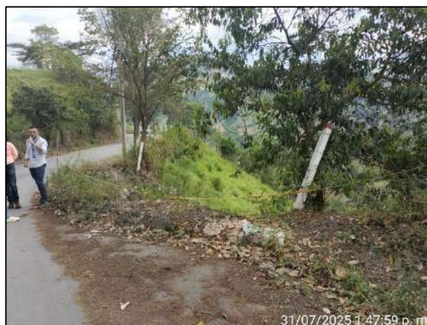
Foto 10. K1+400. Pavimento deteriorado
