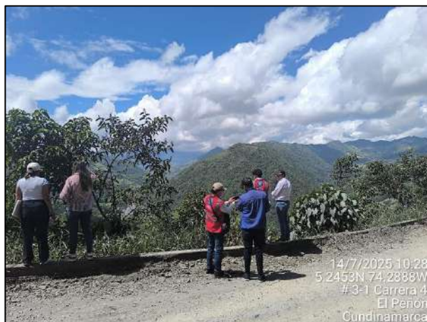
Foto 7. K0+400. Sitio crítico No. 8 – Muro de contención.
