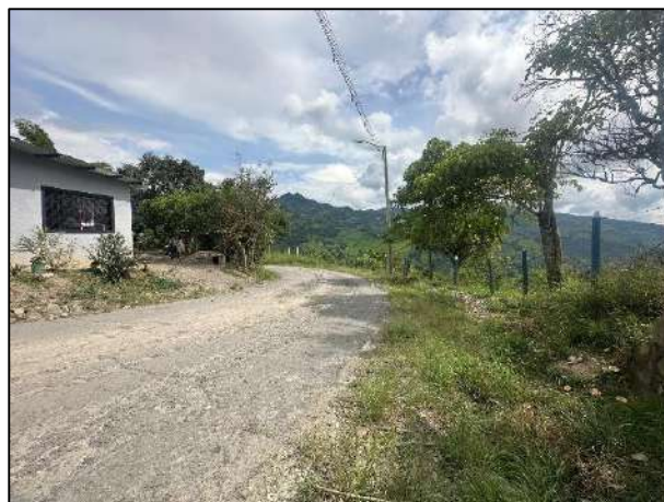
Foto 10. K1+400. Pavimento deteriorado
