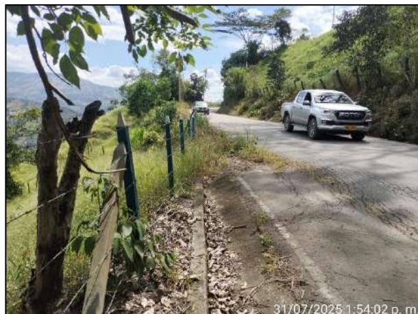
Foto 2. K0+150. Deterioro de capa de pavimento.
