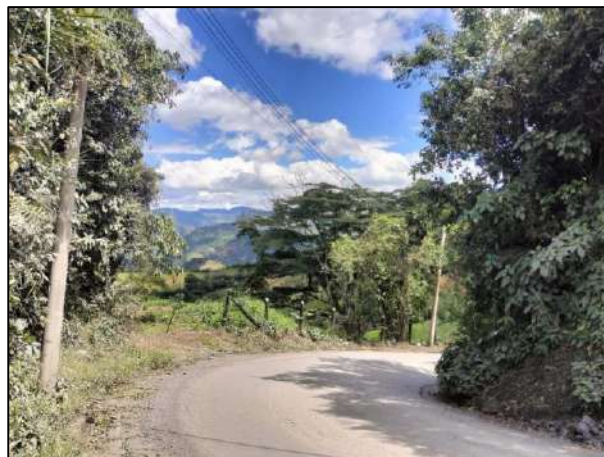
Foto 2. K0+150. Deterioro de capa de pavimento.
