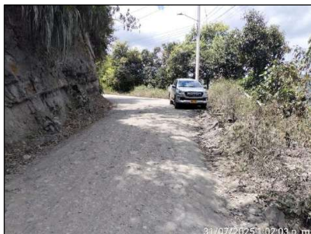
Foto 4. K0+450 – K0+350. Sitio crítico No. 8 – Muro de contención.
