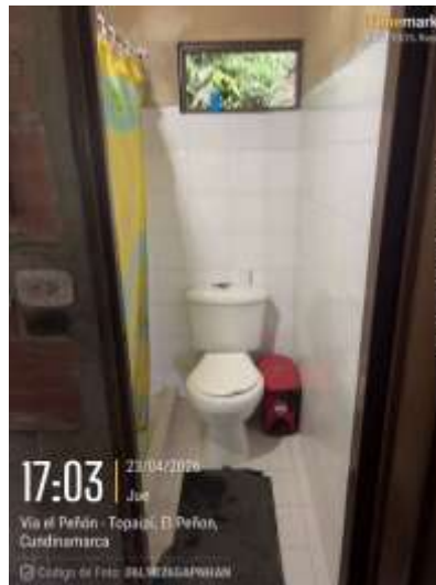
Fotografía 12. Unidad sanitaria en obra
