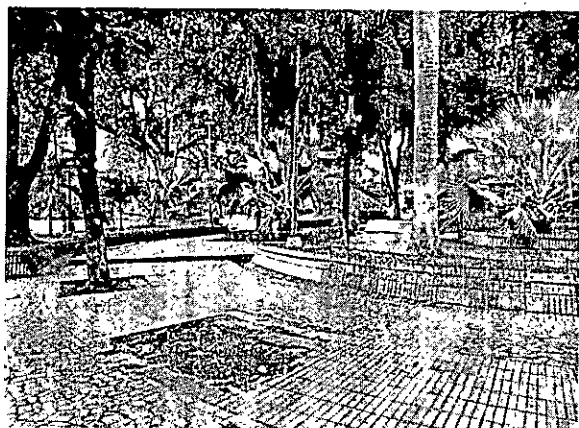
Foto 03: Estado actual Parque-materas y adoquín en deterioro. Fuente registro fotográfico: Proyecto
