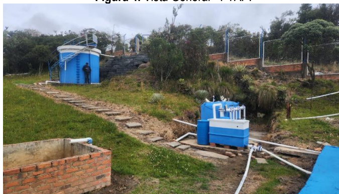
Figura 4. Vista General - PTAP.
