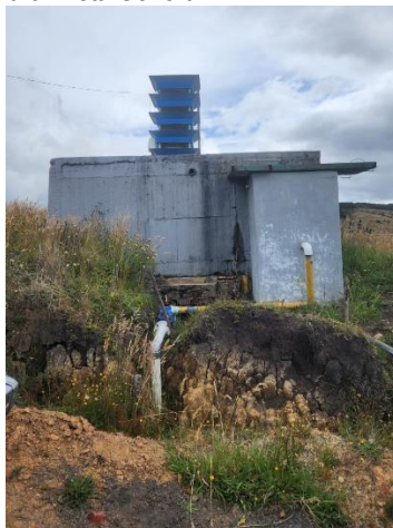
Figura 3. Vista General - PRETRATAMIENTO.
