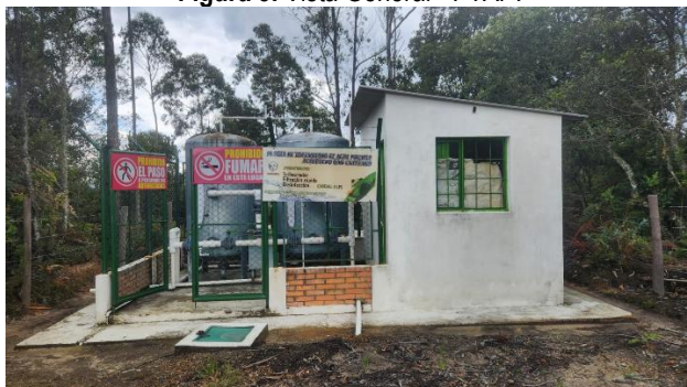
Figura 3. Vista General - PTAP.
