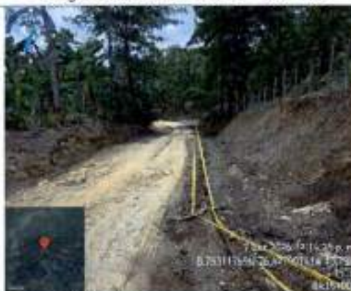
Fotografía No.12 Presencia de aguas subterráneas K15+000
