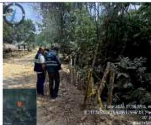
Fotografía No.2 Tablestacas en mal estado K21+000
