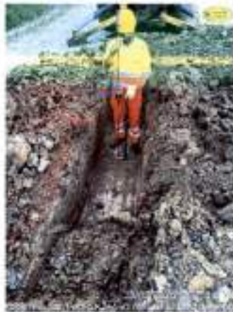
Apique No. 10 K2+650
