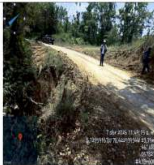
Fotografía No.8 Perdida de banca K18+600
