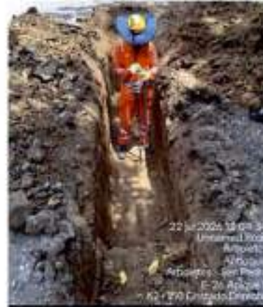
Apique No. 8 K2+150
