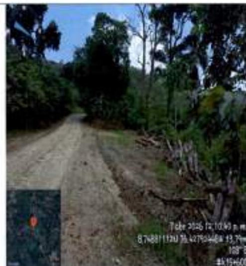
Fotografía No.14 bolsas de agua en vía K15+600
