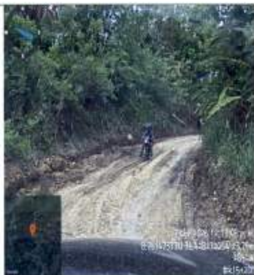
Fotografía No.13 bolsas de agua en vía K15+200
