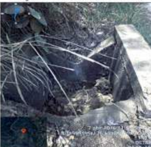
Fotografía No.6 Obras colmatadas k18+600
