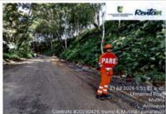
Verificación de controladoras viales en intermedios
