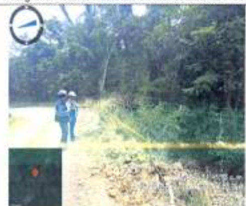
Fotografía No.4 Socavación de vía K19+200
