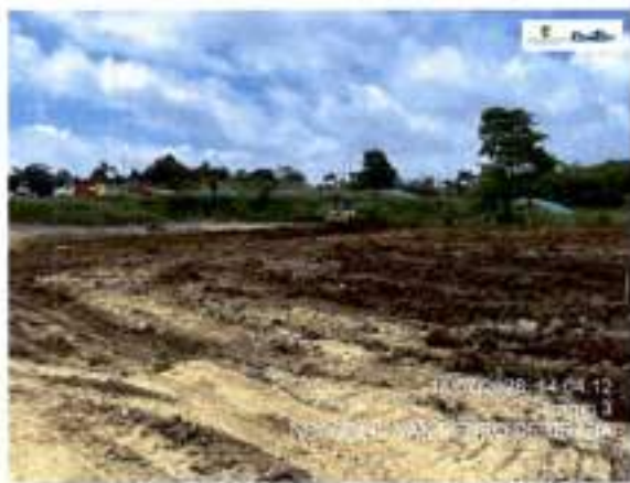
Zona de campamento previsto como ZODME K0+400, sin autorización previa por la interventoría.
