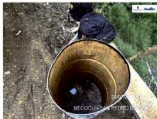
Acopio inadecuado del recurso hídrico para actividades constructivas
