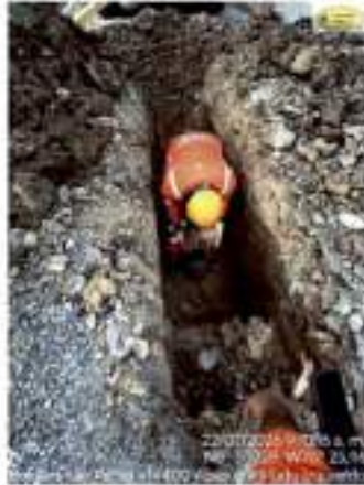
Apique No. 5 K1+400
