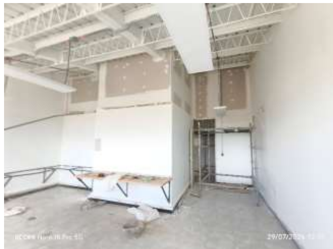
7. □ Drywall 4to piso salones informática.
