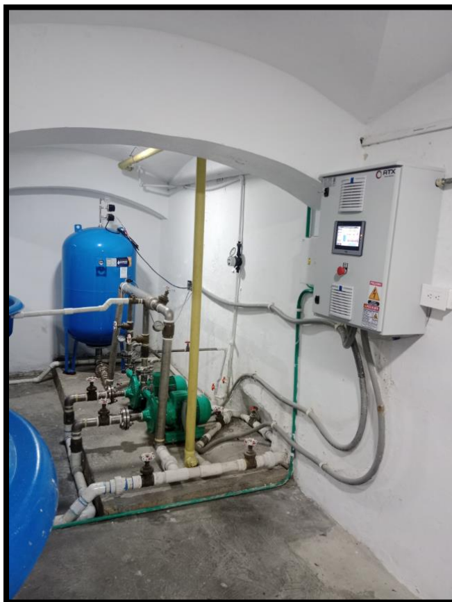
Cuarto de Bombas sótano sede Centro
