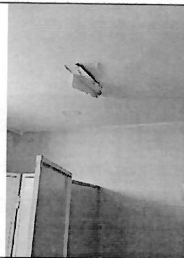
Foto 8: Cieloraso que requiere resane.
