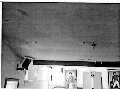
Foto 7: Estructura de cieloraso que presenta afectación en el auditorio de sesiones, por las filtraciones en viga canal
