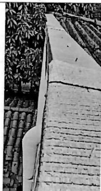
Foto 9: Cubierta que requiere cambio del manto asfáltico.
