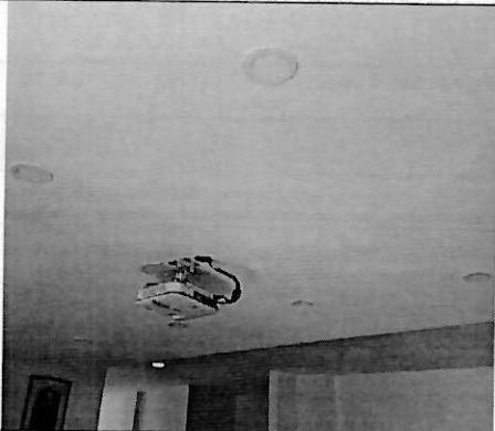
Foto 11: Luminarias LED que requieren cambio.
