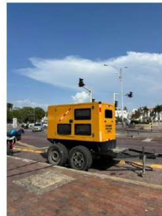
Fotografía 4. Planta eléctrica instalada como respaldo para garantizar el suministro de energía y la continuidad de los equipos técnicos durante la jornada.
