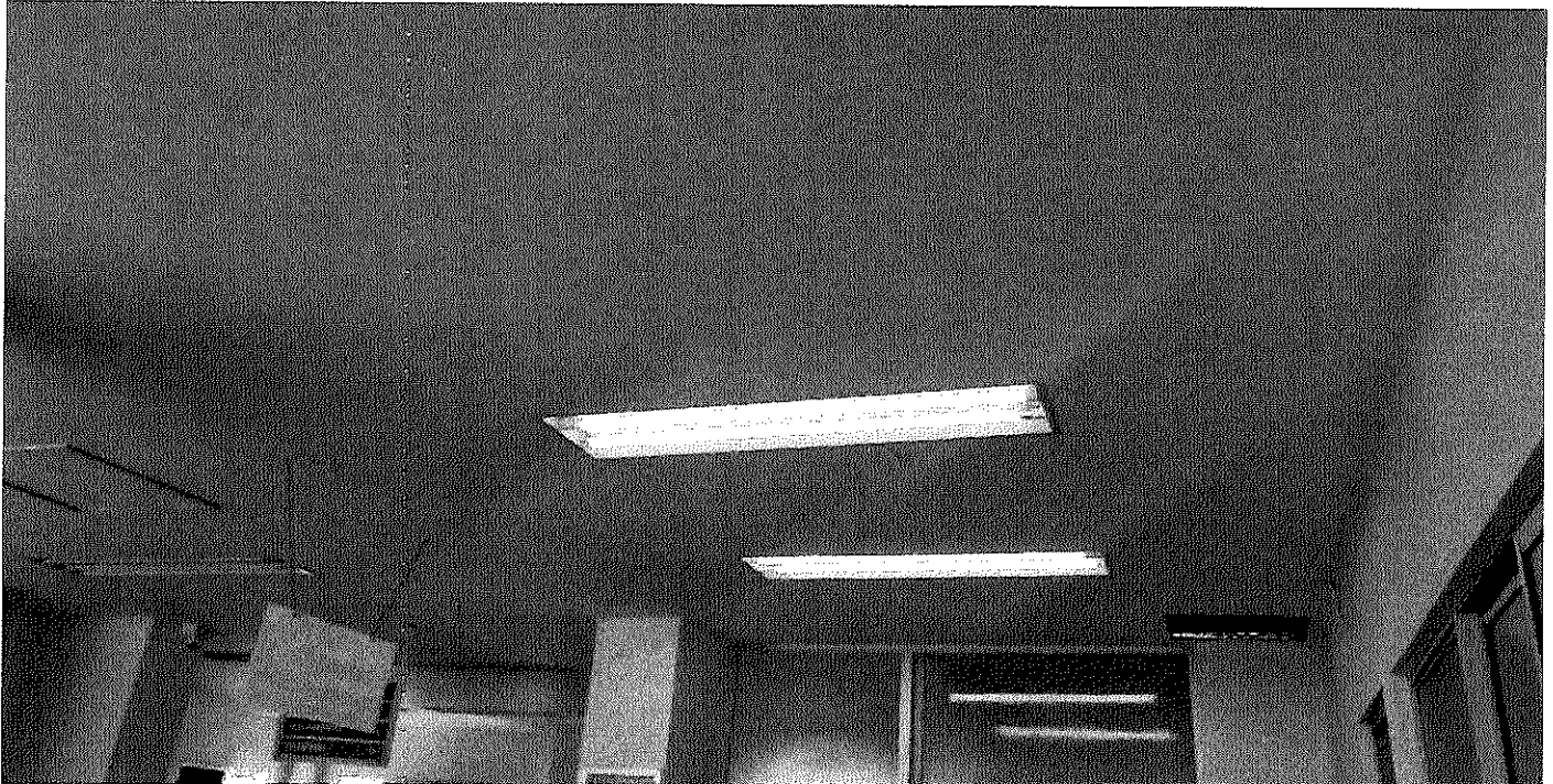
Cielo raso en mal estado del área de observación en urgencias.
