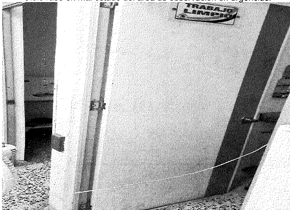
Puertas en madera que requieren cambio en el servicio de urgencias.
