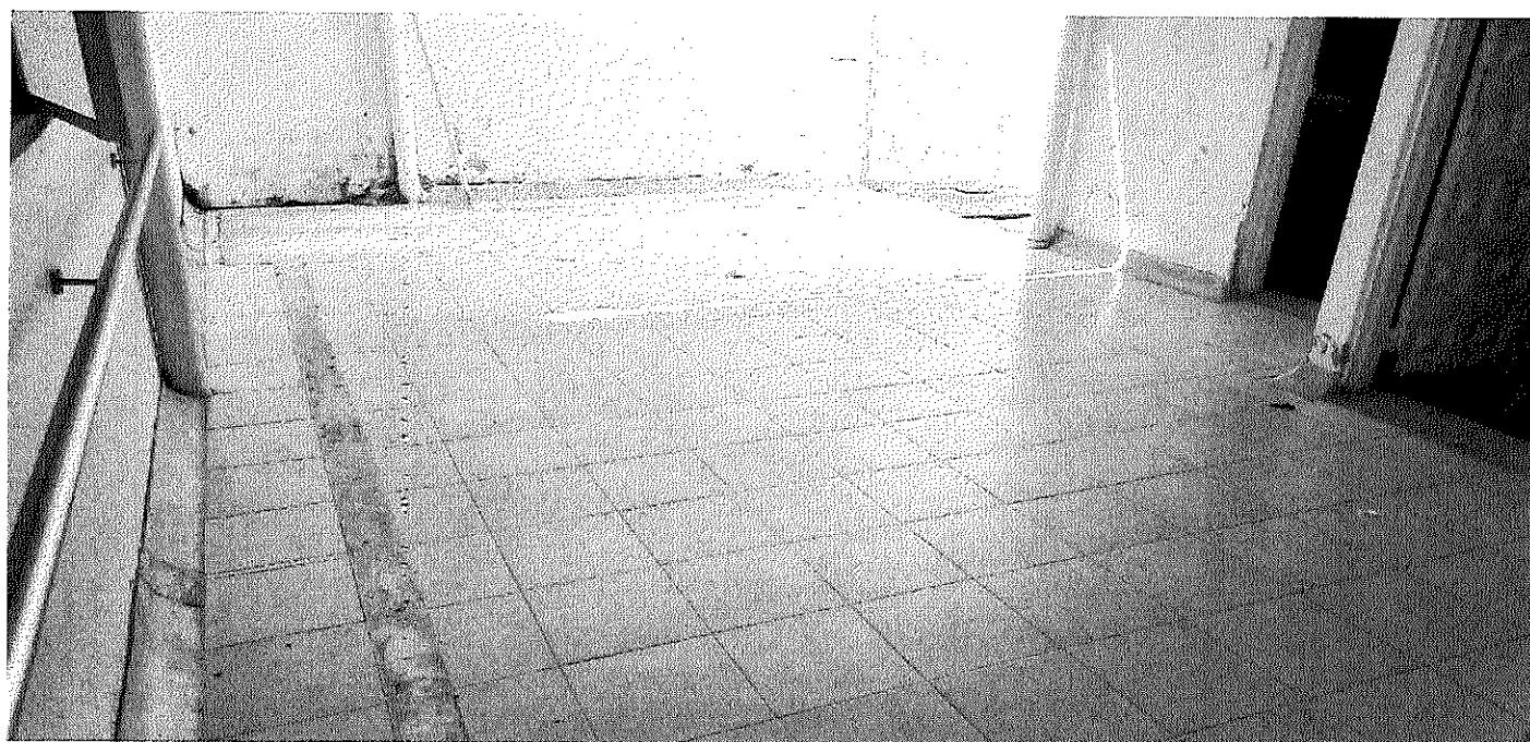
Piso para cambio salida de los baños de odontología – Baldosas en mal estado
