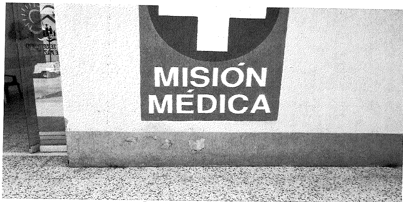
Paredes de fachada en deterioro
