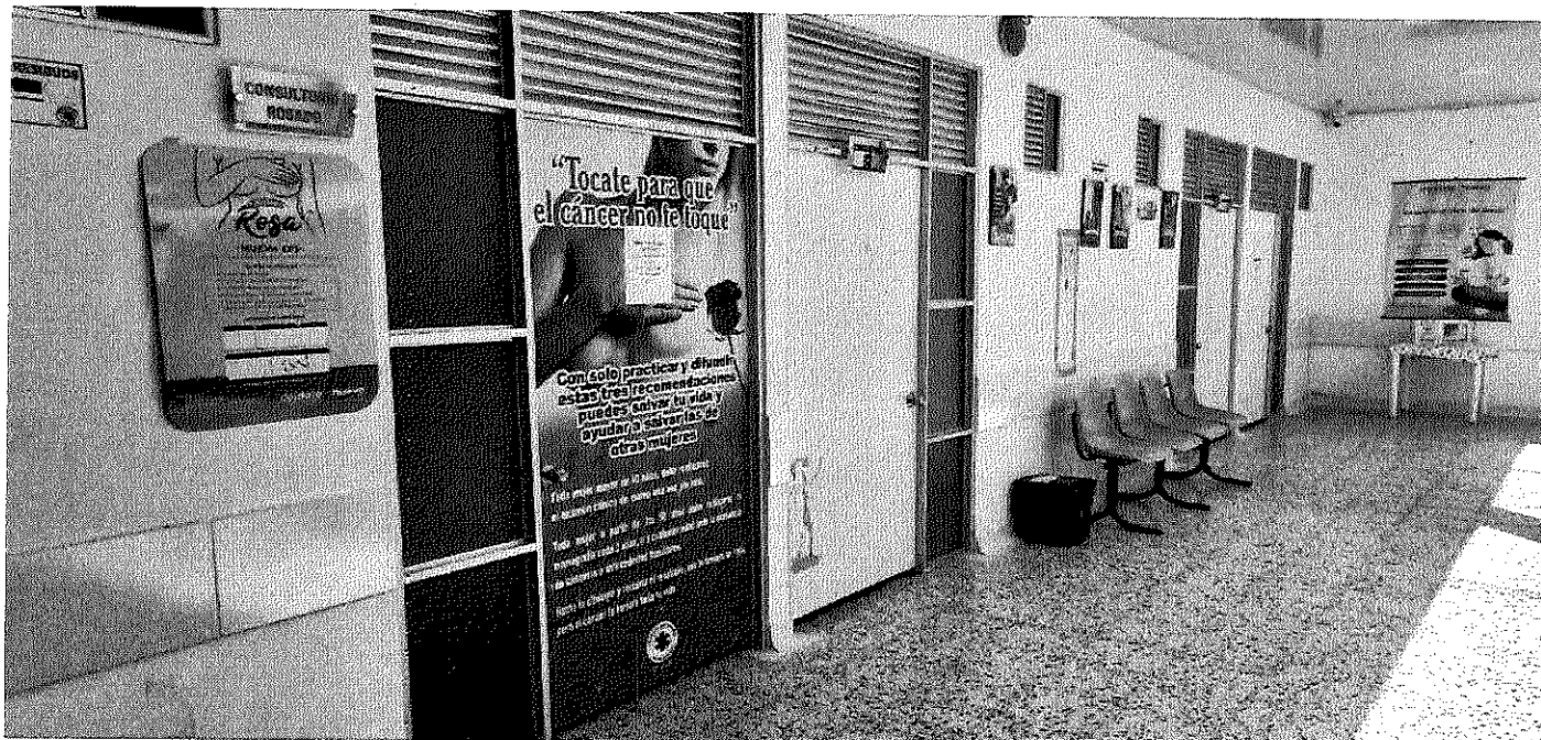
Puertas de los consultorios para cambio. Actualmente en madera.
