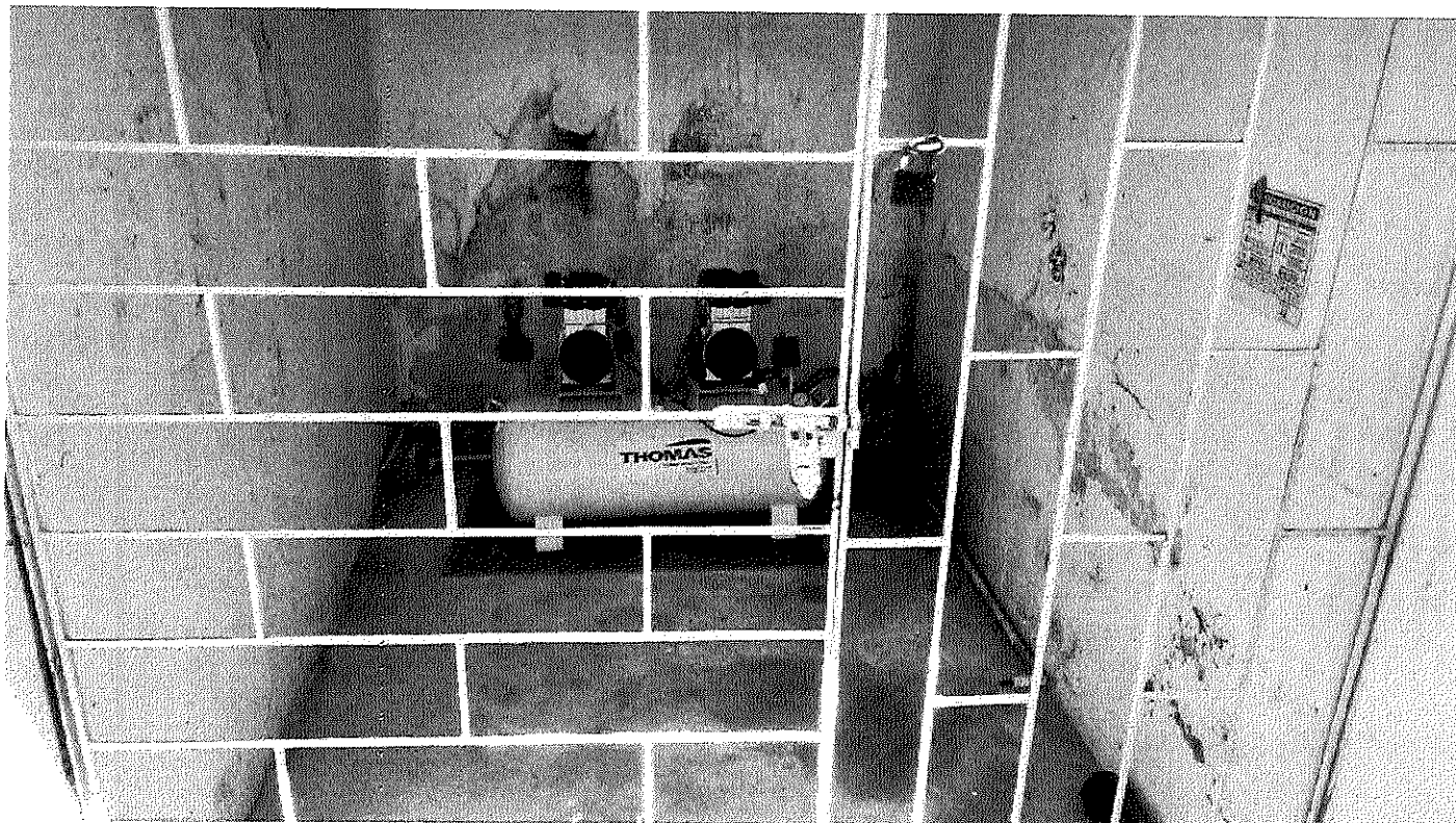
Cuarto de compresor Odontología detrás de los baños
