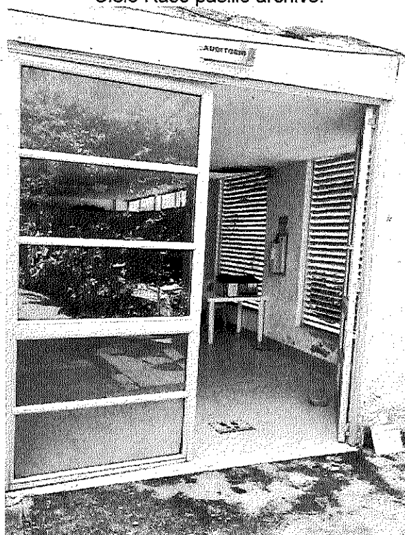
Puerta en mal estado – Requiere cambio
