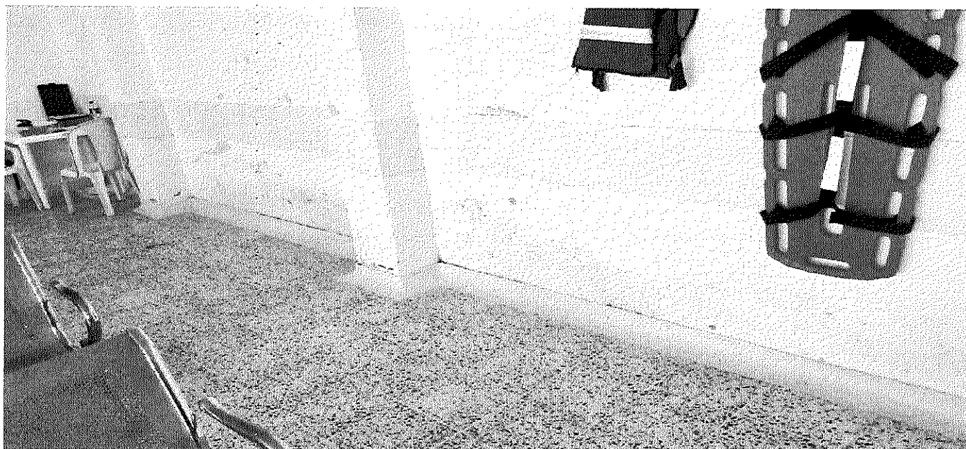
Humedad en paredes.
