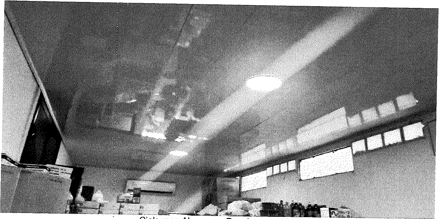
Cielo raso Almacén – Requiere cambio.
