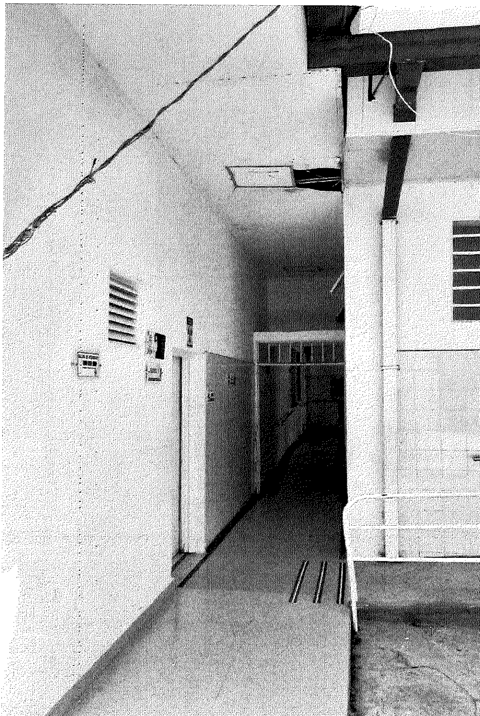
Dry wall en mal estado pasillo Rayos X
