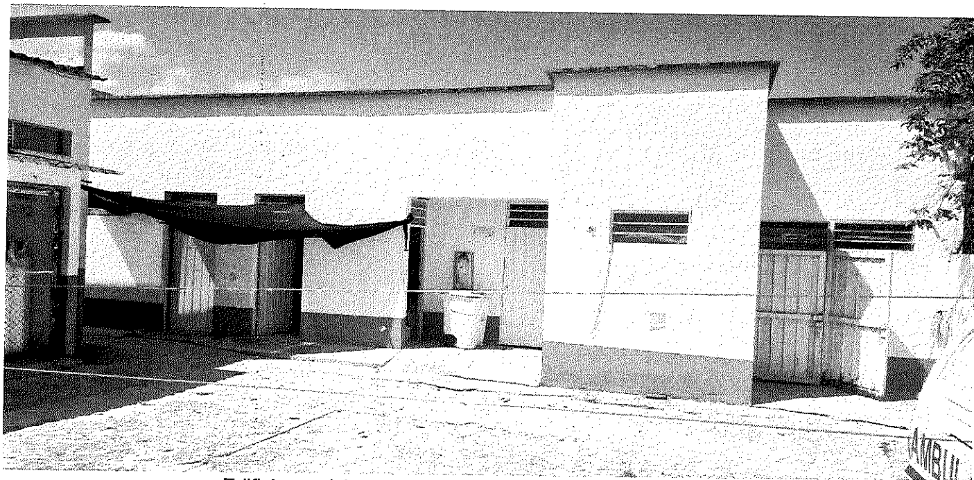
Edificio servicios generales, todas las puertas en mal estado
