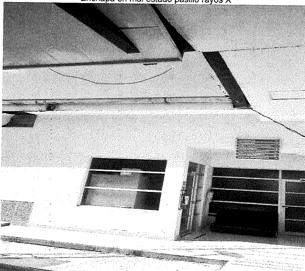
Pasillo de Rayos X y Laboratorio: dry wall en mal estado – Paredes exteriores de gerencia en mal estado.
