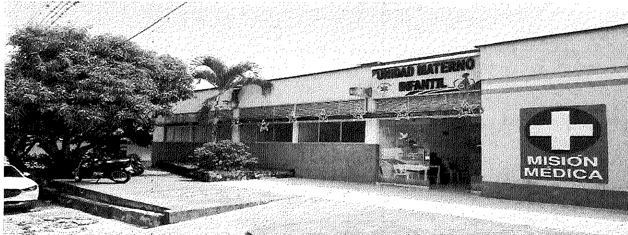
Fachada Materno Infantil. Paredes deterioradas
