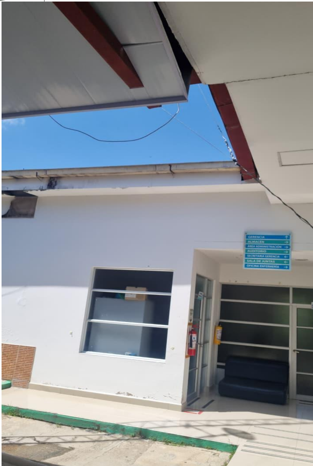
Pasillo de Rayos X y Laboratorio: dry wall en mal estado – Paredes exteriores de gerencia en mal estado.
