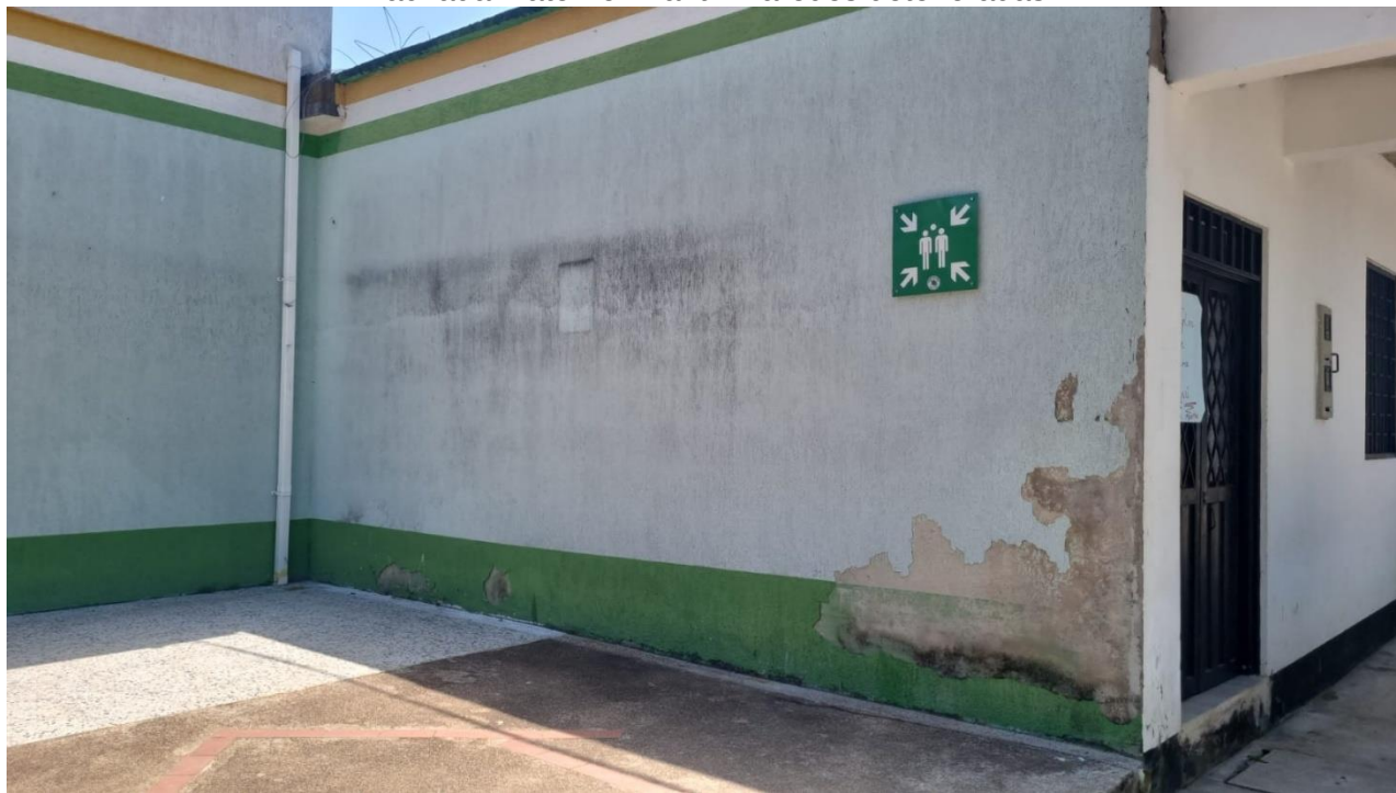
Paredes de fachada en deterioro
