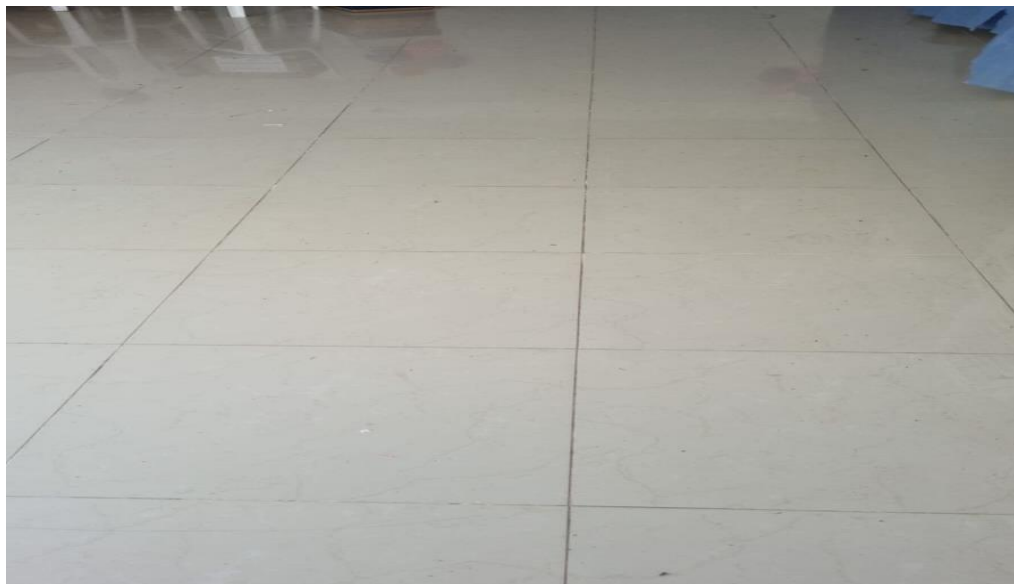
Piso auditorio requiere mantenimiento
