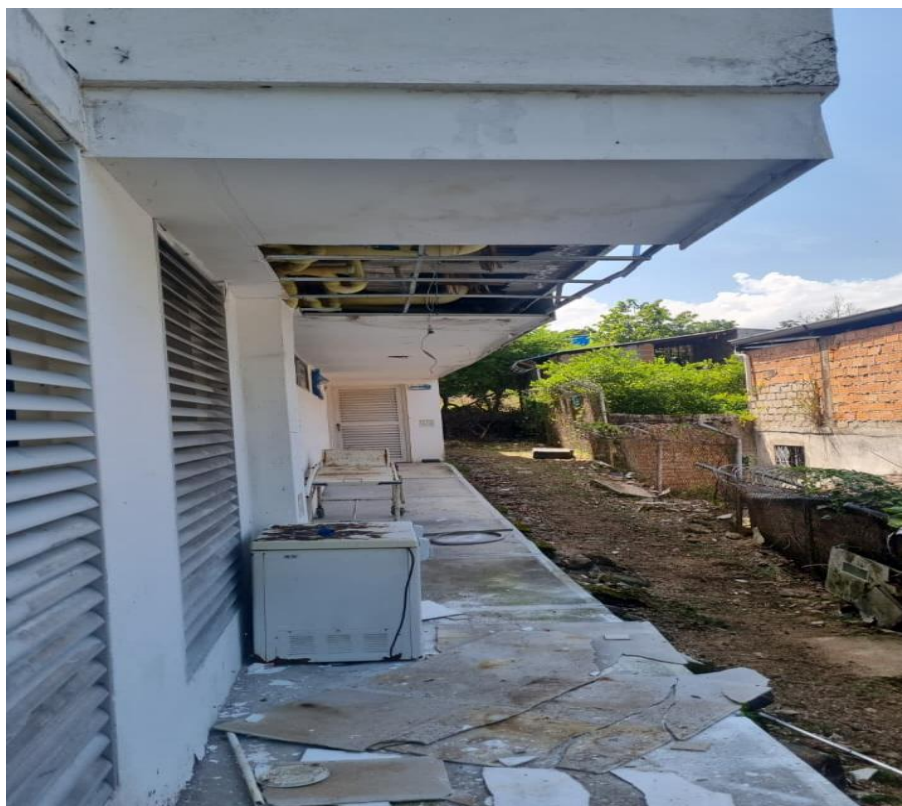
Pasillo Archivo, Cielo raso y paredes en mal estado.
