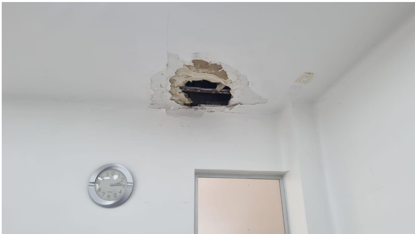
Procedimientos Urgencias – Cielo raso en mal estado.
