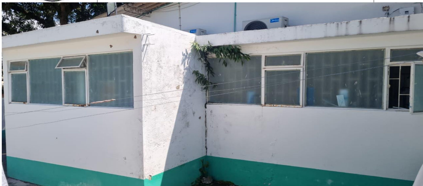
Parte posterior de odontología y almacén – Paredes en mal estado. Ventanas Para cambio.
