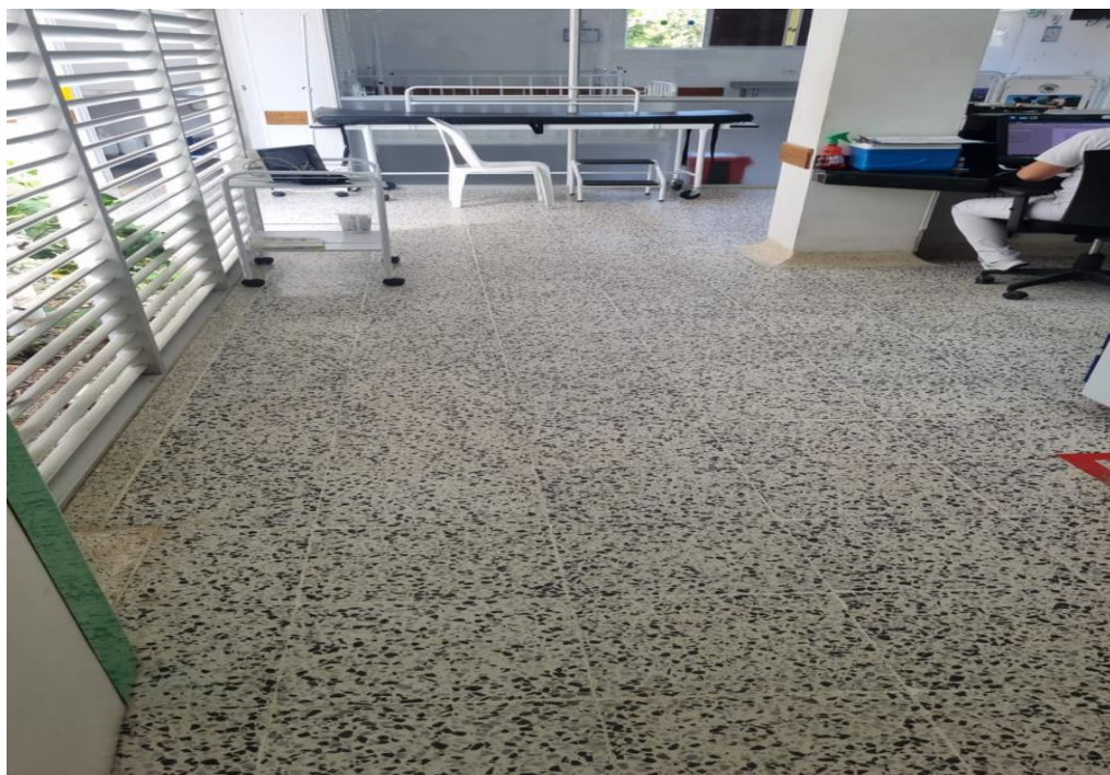
Mantenimiento, troquelado y brillo requerido.
