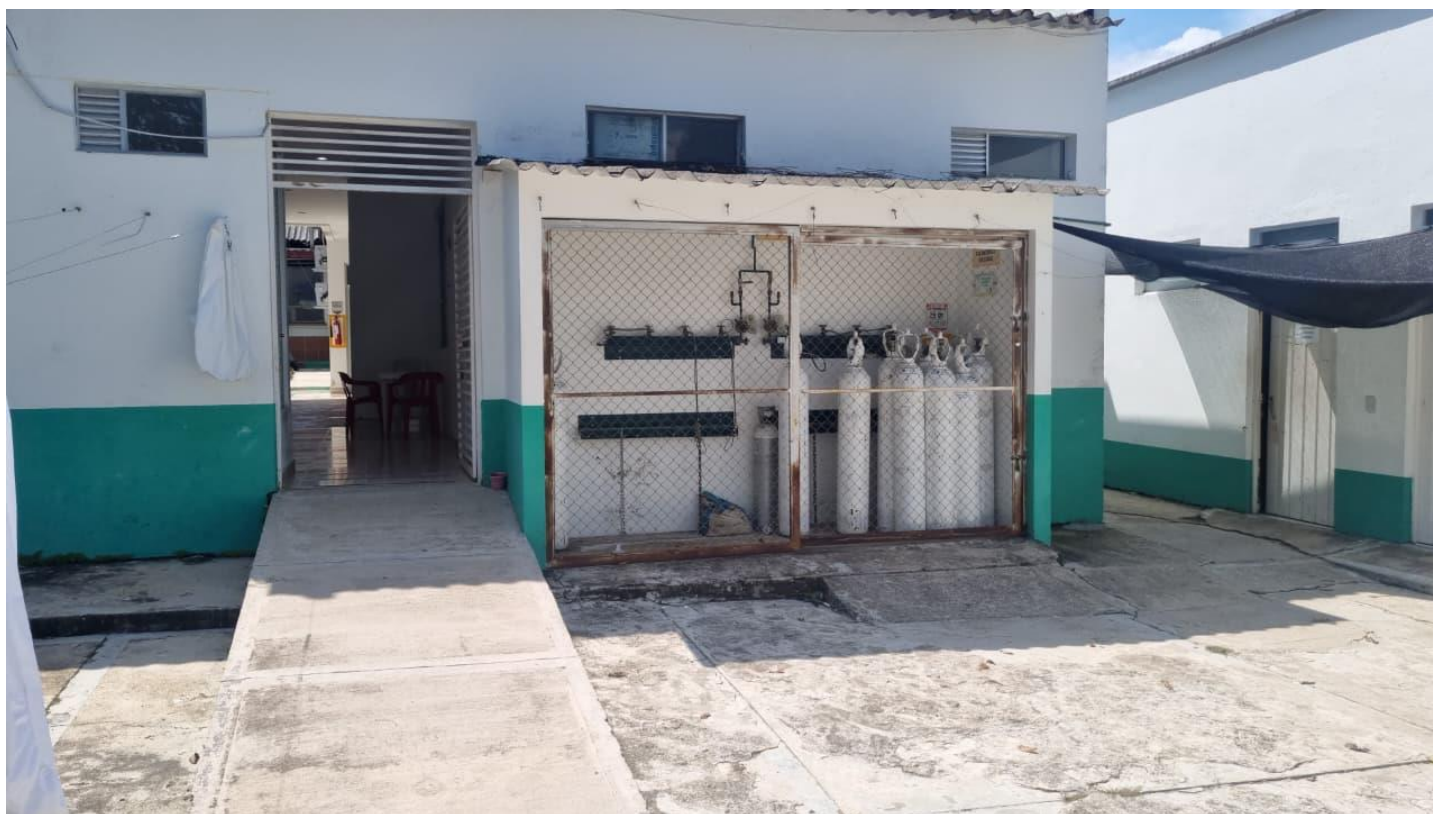
Manifold red de oxígeno detrás de administración
