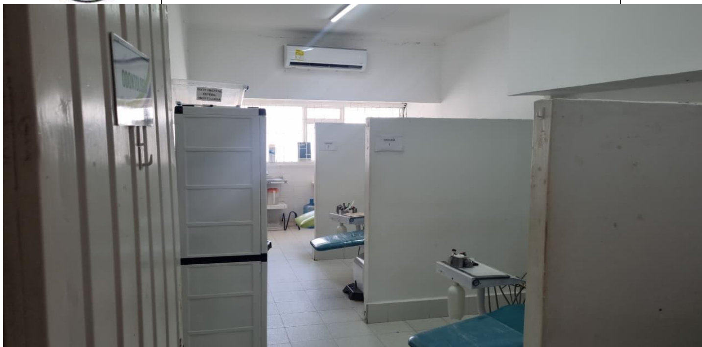
Divisiones cubículos odontología, cielo raso en dry wall, falta media caña en las divisiones.
