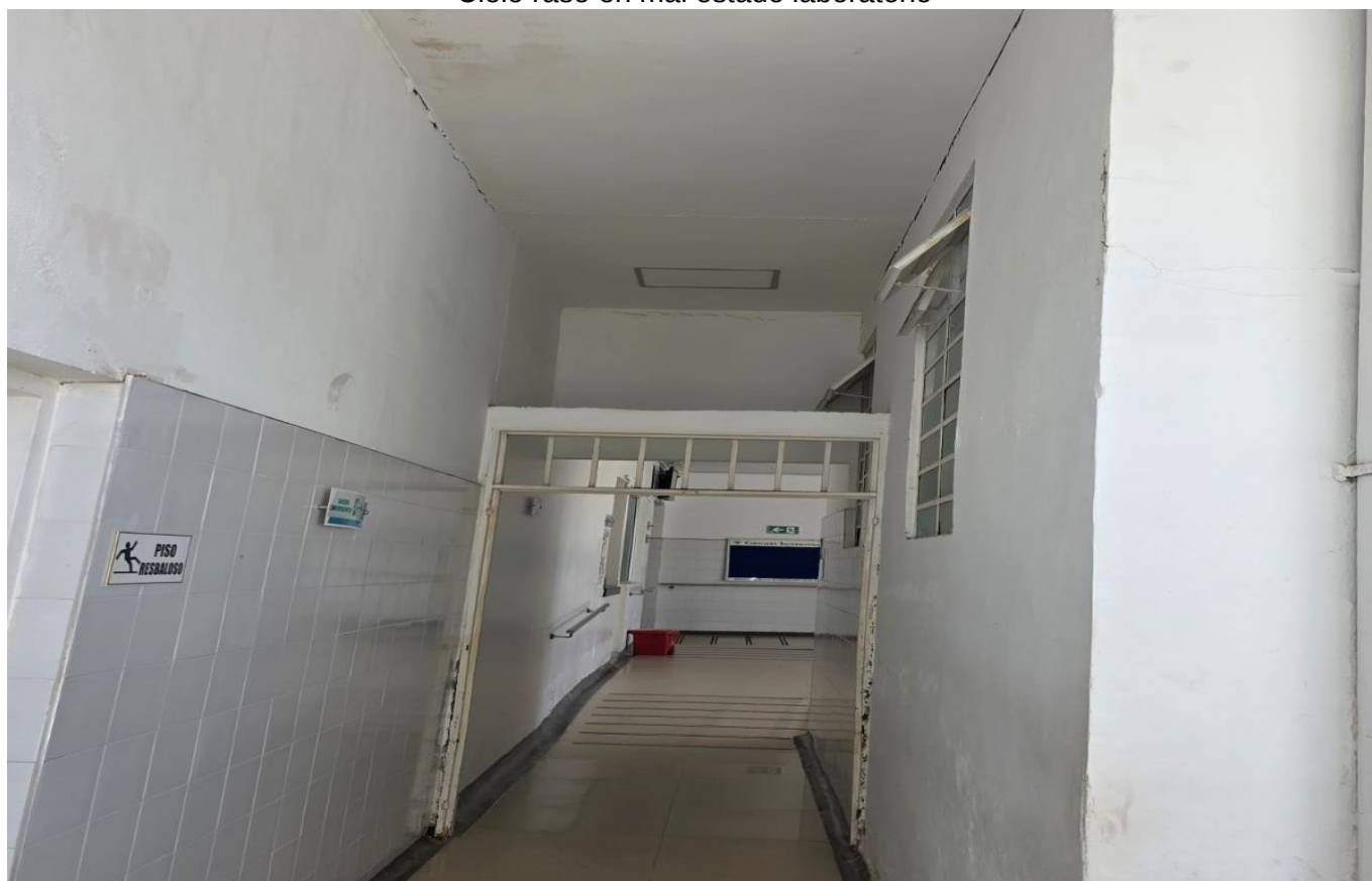
Cielo raso, paredes y enchape en mal estado pasillo laboratorio
