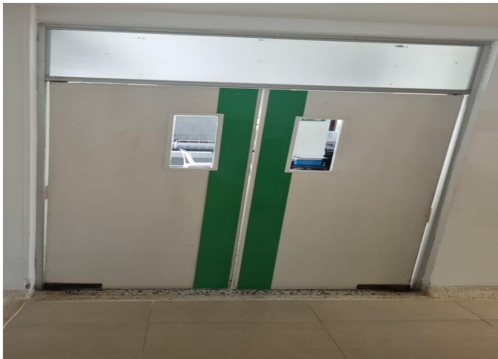
Puertas de Urgencias en madera requieren cambio – (Reanimación)
