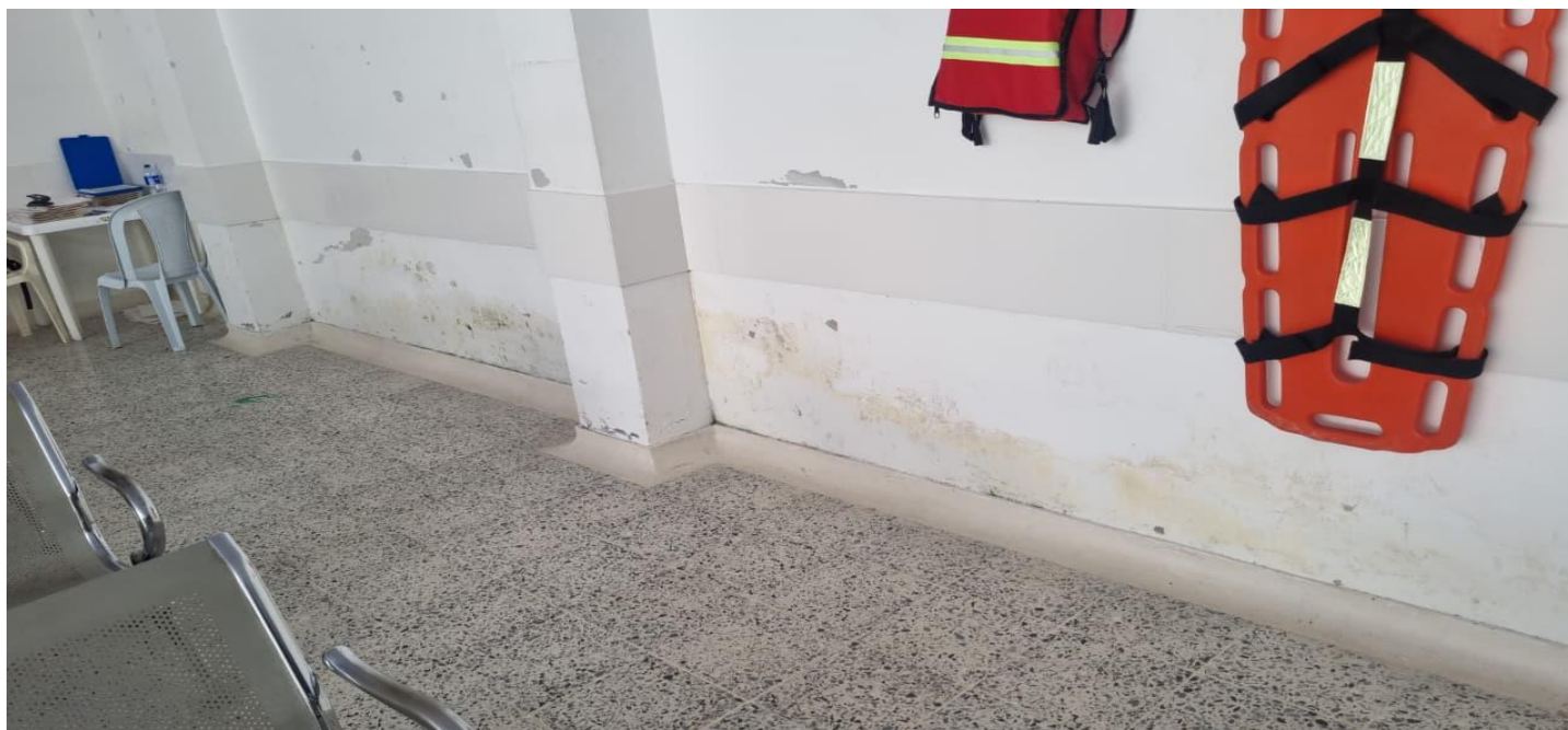
Humedad en paredes.
