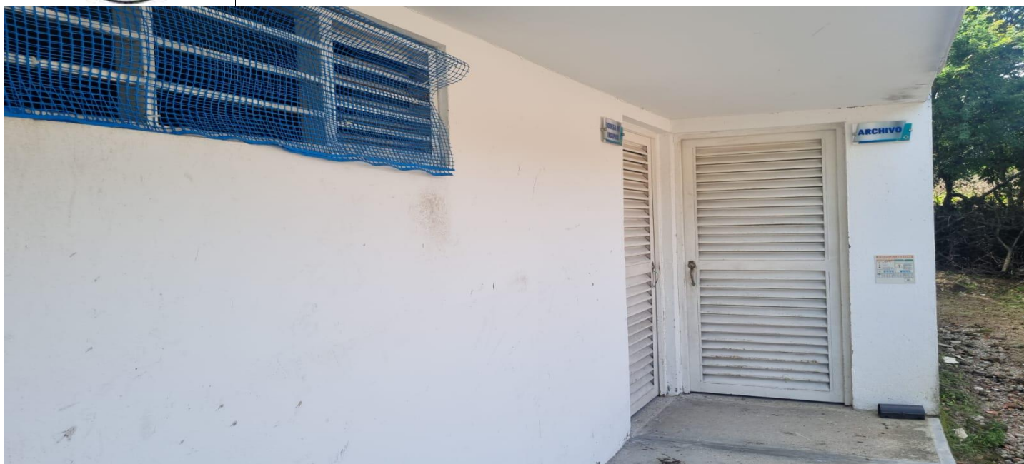
Bodega de insumos y archivo – Puertas Oxidadas.
