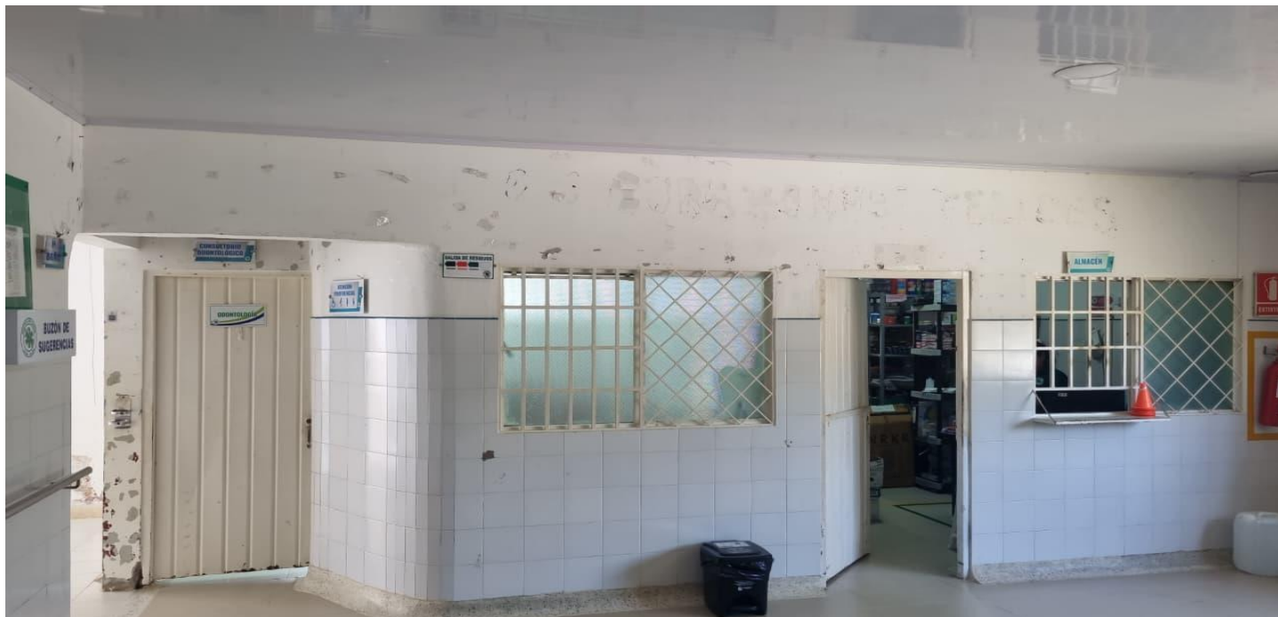
Entradas Odontología- Almacen – Paredes, puertas y ventanas en mal estado
