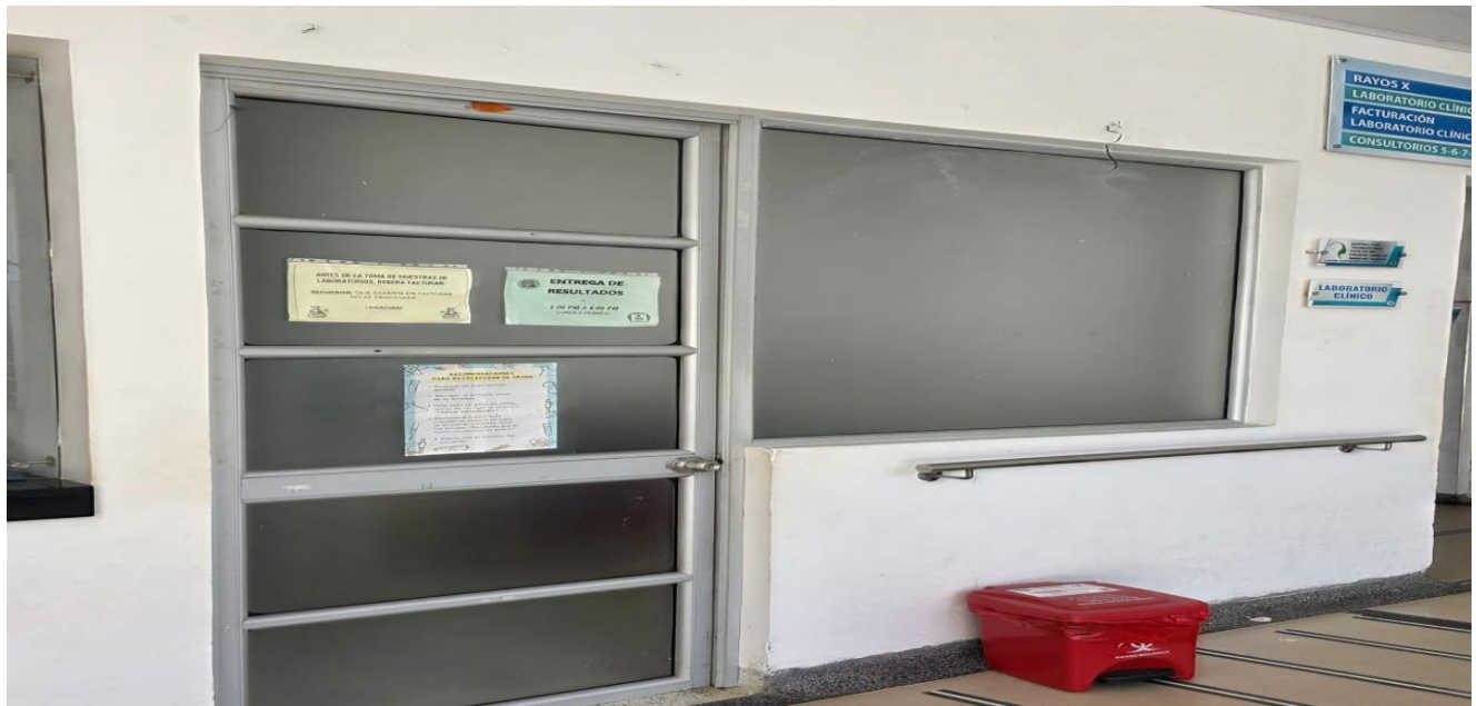
Puerta de laboratorio en mal estado.
