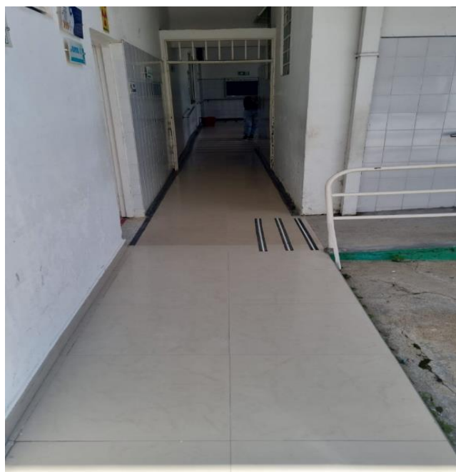
Enchapa en mal estado pasillo rayos X
