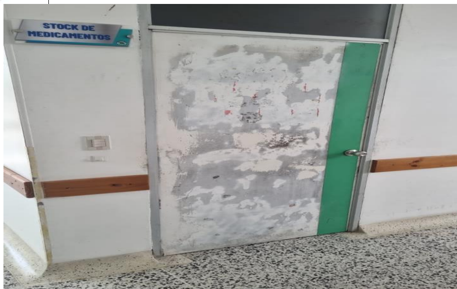
Puertas en urgencias en mal estado.
