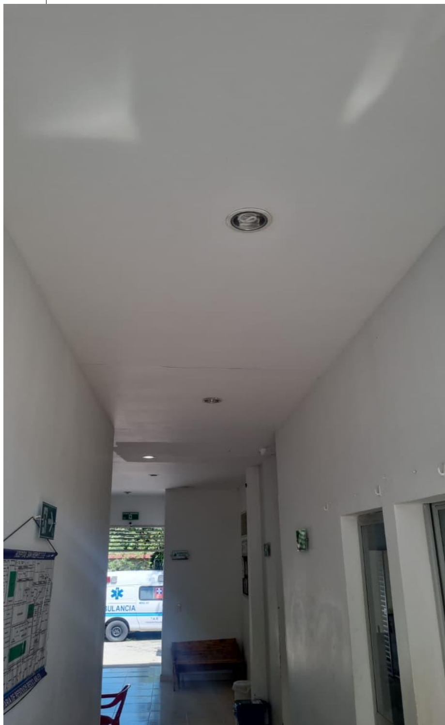
Dry wall en mal estado pasillo Administrativa
