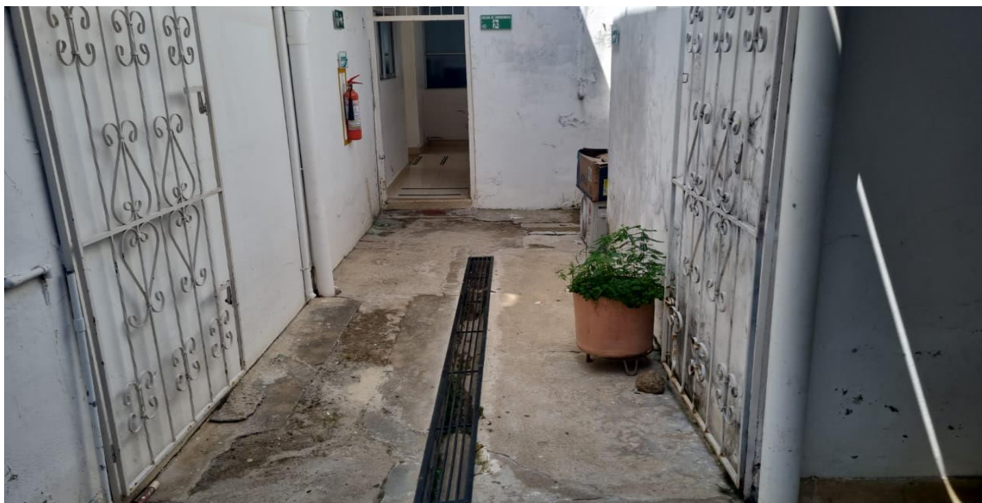
Pisos en cemento y mal estado pasillo de odontología y administración.
