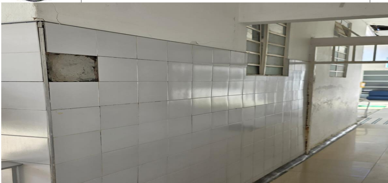
Enchape en mal estado pasillo laboratorio
