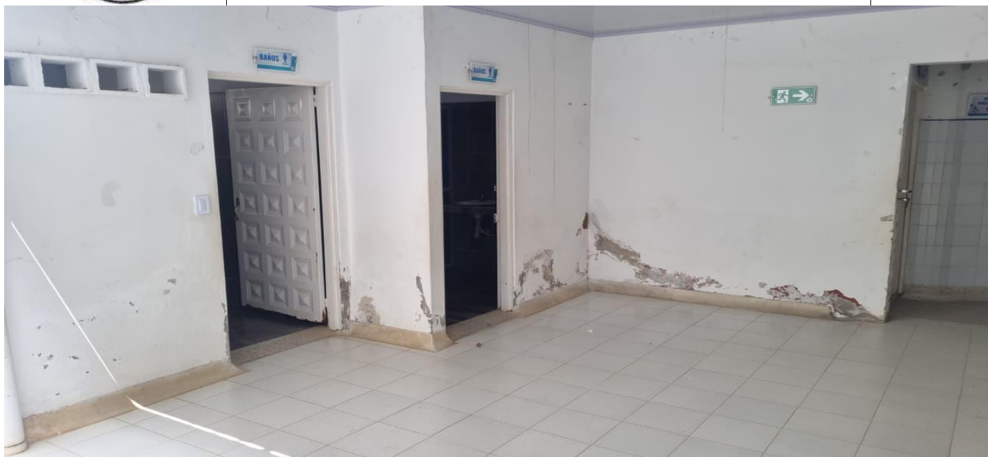
Baños Odontología – Paredes en mal estado. Puertas malas.
