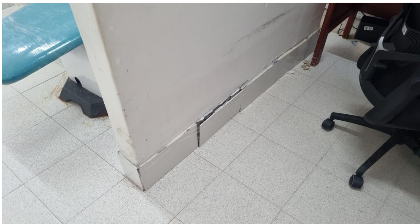
Piso para cambiar – Baldosas en mal estado.
