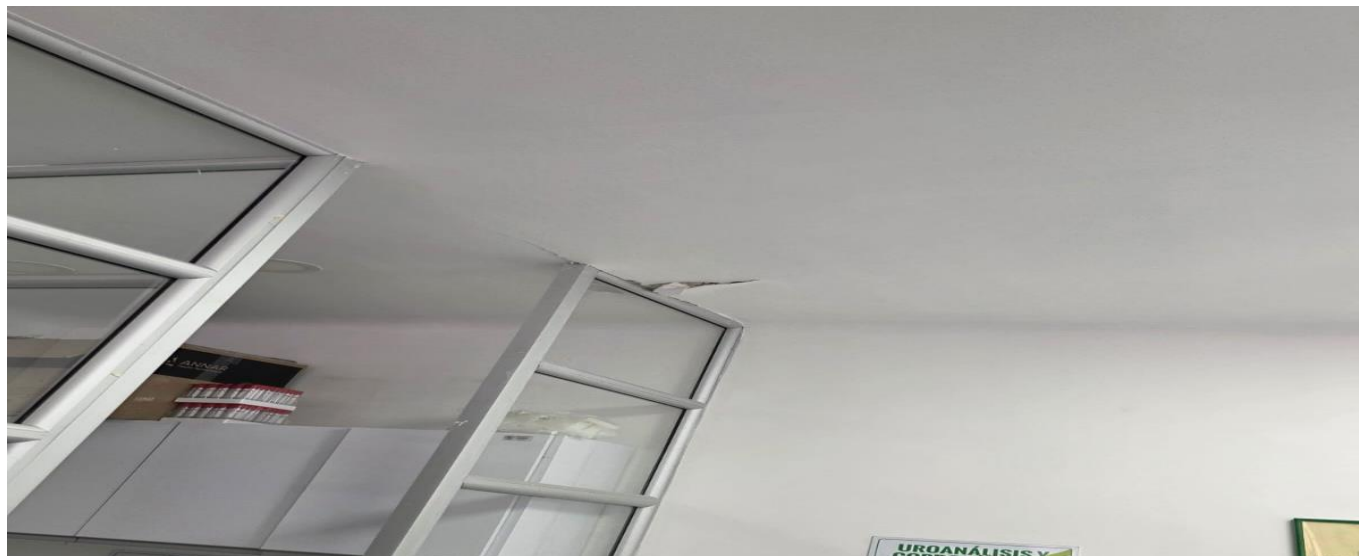
Cielo raso en mal estado laboratorio
