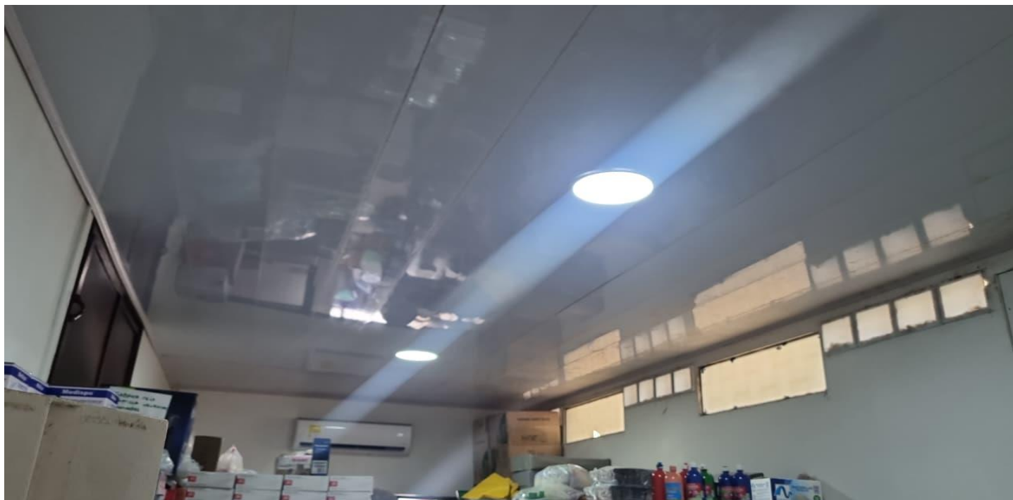
Cielo raso Almacen – Requiere cambio.
