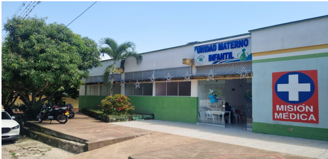
Fachada Materno Infantil. Paredes deterioradas
