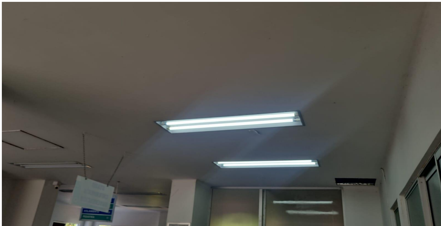
Cielo raso en mal estado del área de observación en urgencias.
