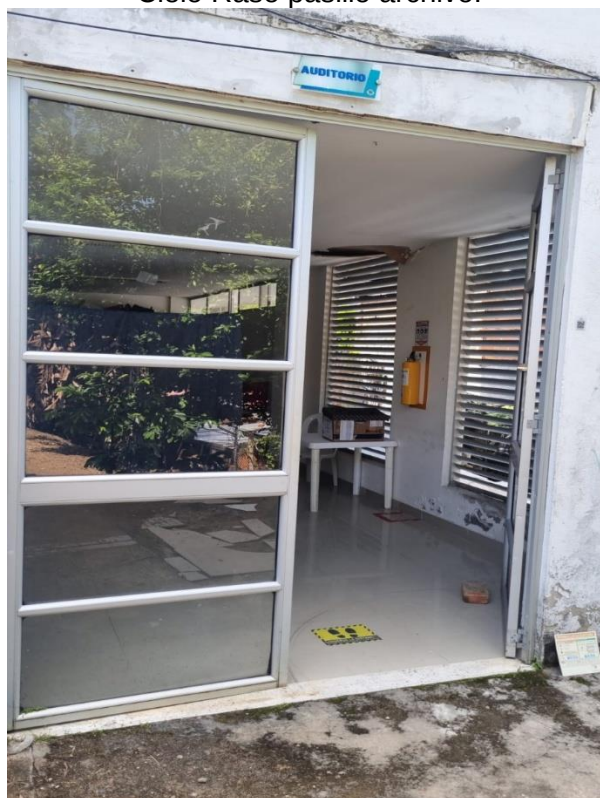
Puerta en mal estado – Requiere cambio
