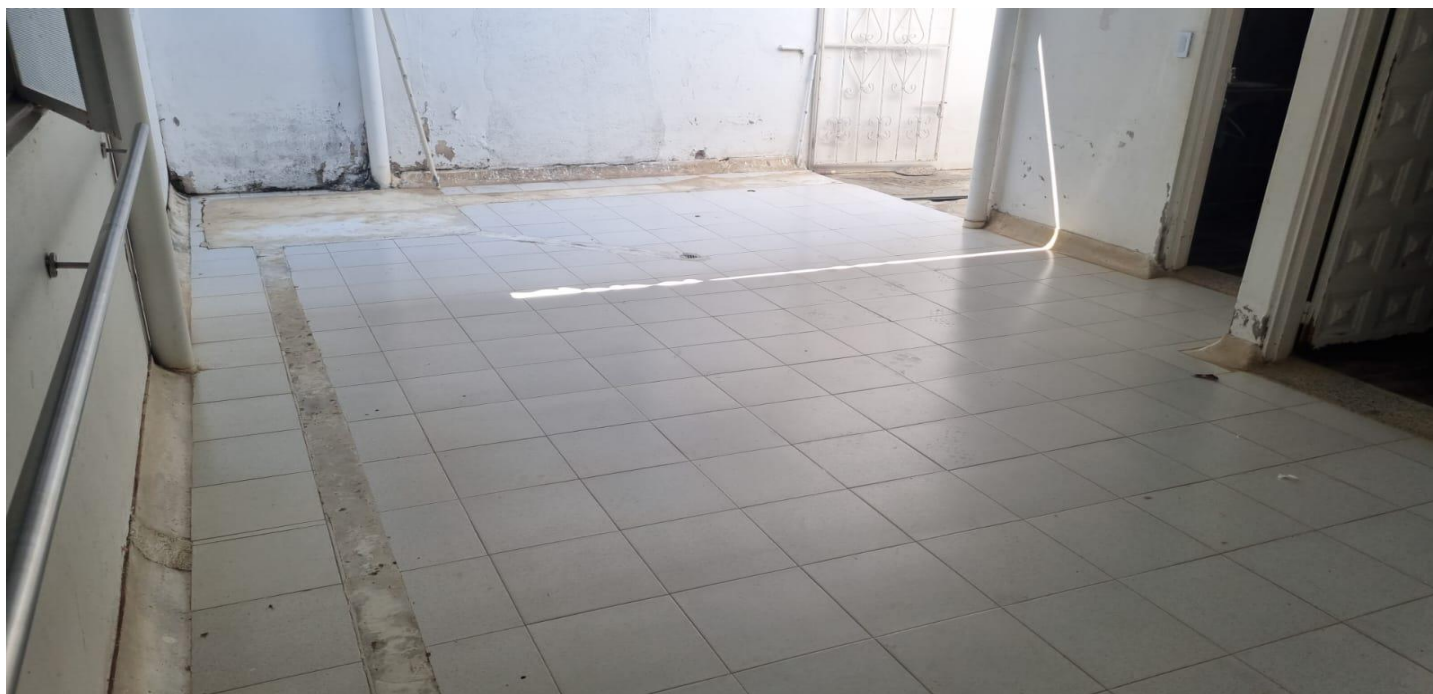
Piso para cambio salida de los baños de odontología – Baldosas en mal estado
