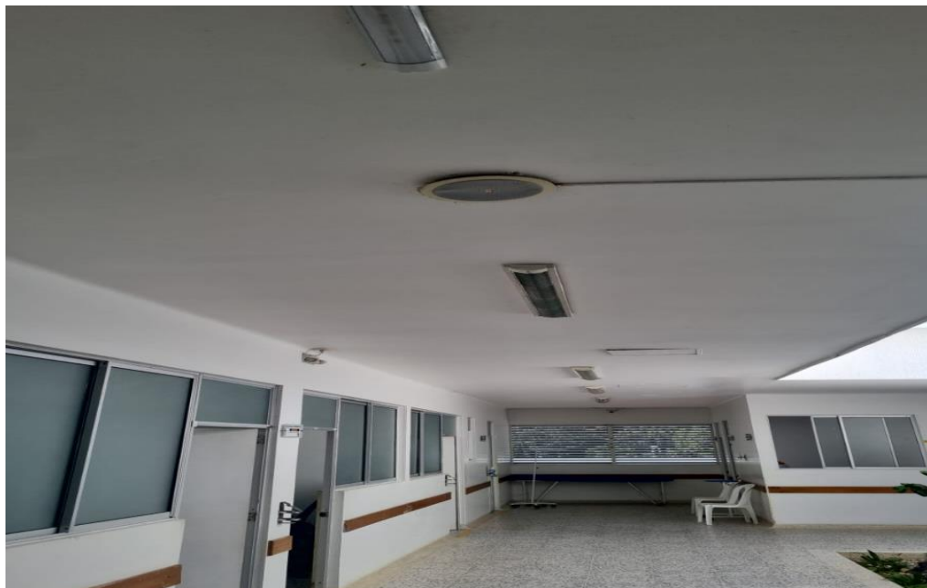
Cielo raso en dry wall en mal estado.
