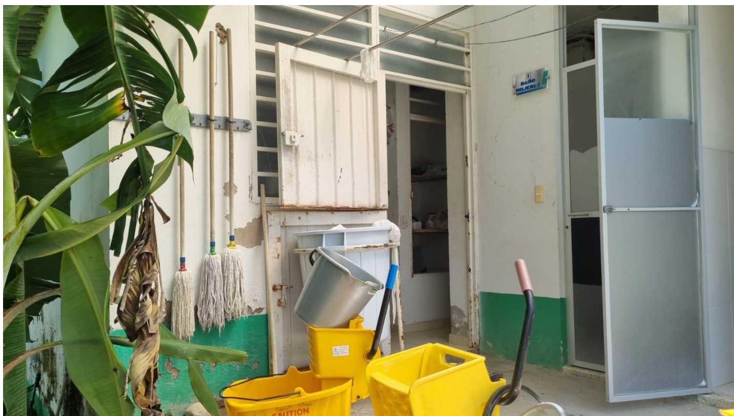
Parte posterior servicios generales – Puertas en mal estado para cambio.
