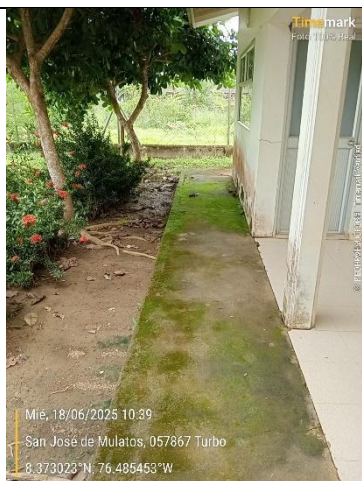
Corredores exteriores con humedad.
