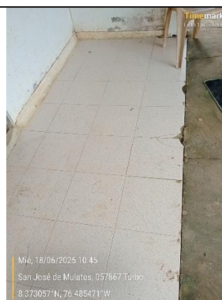
Piso y paredes en mal estado
