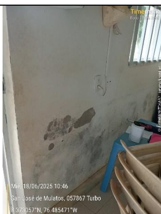
Humedad en paredes internas, falta de cielo raso.
