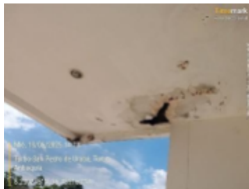
Cielo raso deteriorado por humedades en la cubierta.
