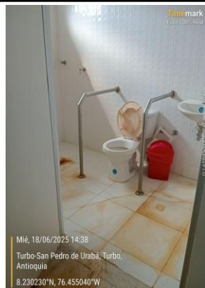
Baños en mal estado, tapas rotas y piso en baldosa lisa
