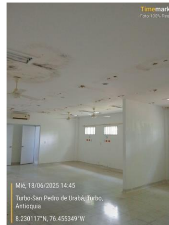
Cielo raso deteriorado por humedades de cubierta
