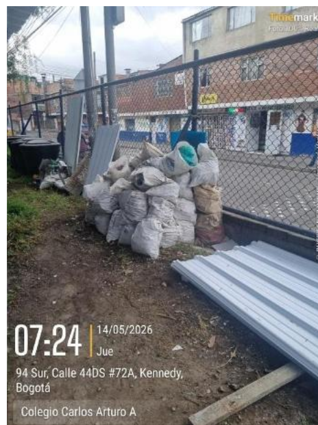
Ilustración 7. Acopio de escombro Colegio Carlos Arturo Torres sede A
