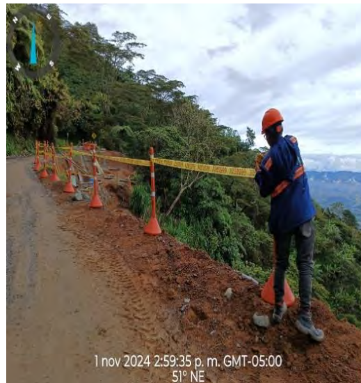
Fotografías No.1: Registro fotográfico ejecución de obra (residuos expuestos en el talud inferior).
