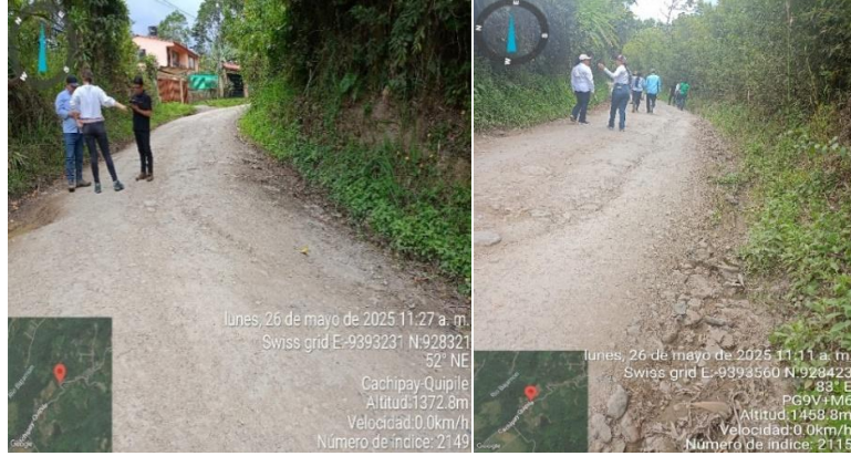
Ilustración 4. Recorrido inicial de obra, condiciones iniciales de la vía.
