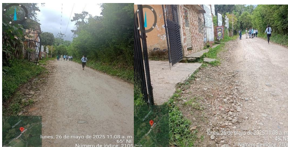
Ilustración 2. Recorrido inicial de obra, condiciones iniciales de la vía.
