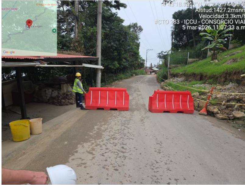
Ilustración 17. Señalización preventiva y cerramientos.
