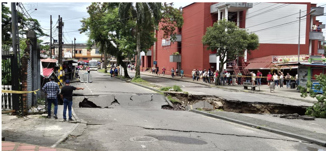
Figura 47. Foto colapso de la estructura Villa Julia. Adoptado de: Periodico del Meta, 2025
