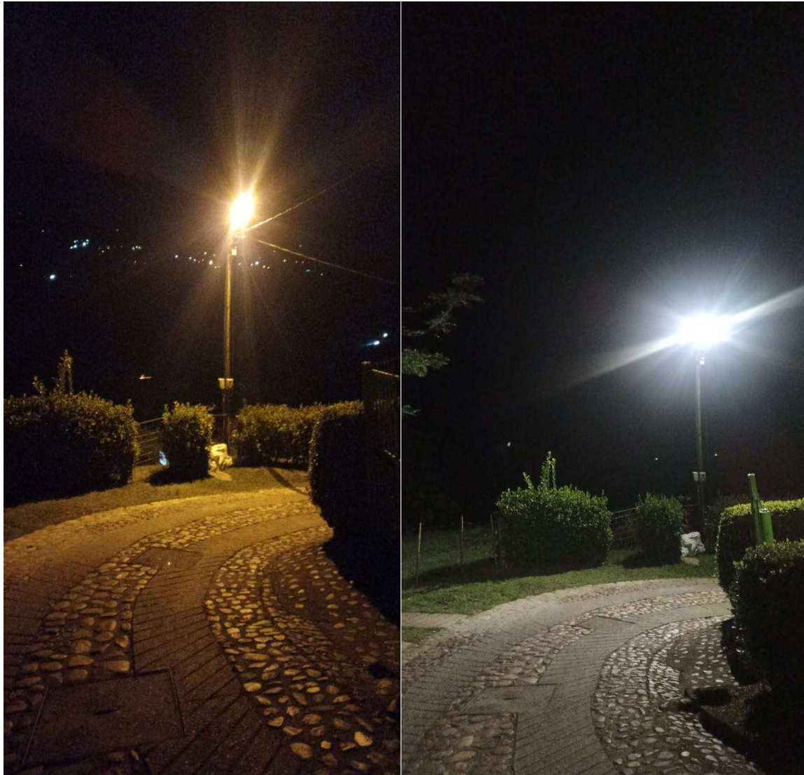
Figura N°14 . Foto: Iluminación de vía antes en sodio y después en LED
