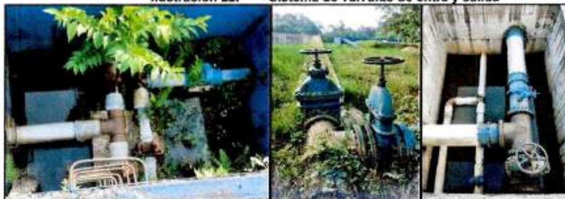
Ilustración 22. Sistema de válvulas de entra y salida
