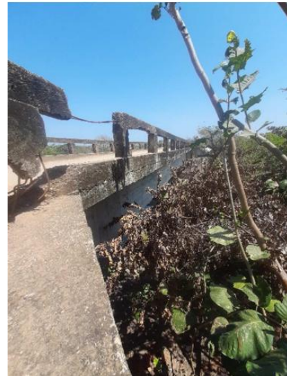
Fotografía 9. Puente 3 Corrosión en acero expuesto.
