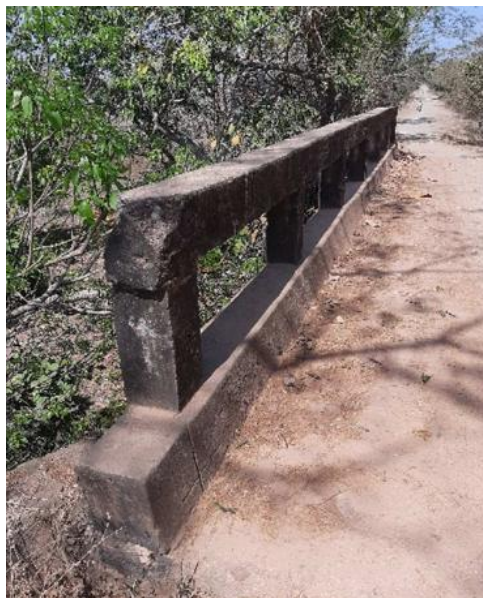
Fotografía 10. Puente 4, barandas con desportillamiento.
