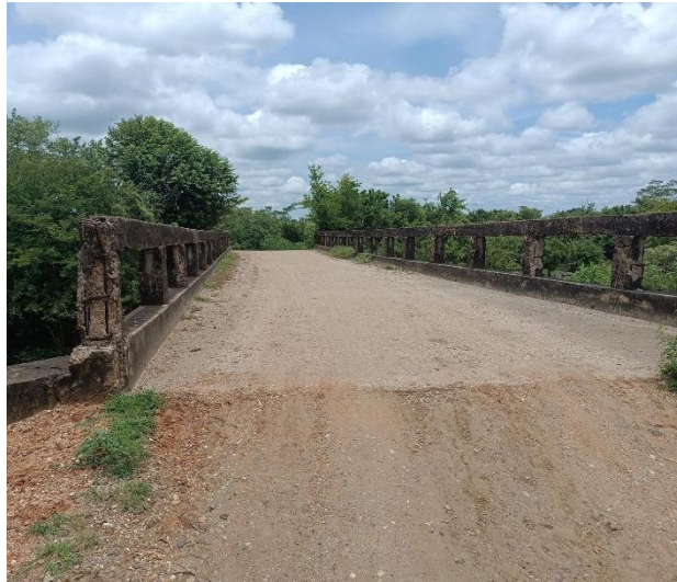
Fotografía 8. Puente 2 barandas con presencia de desportillamiento y acero expuesto.
