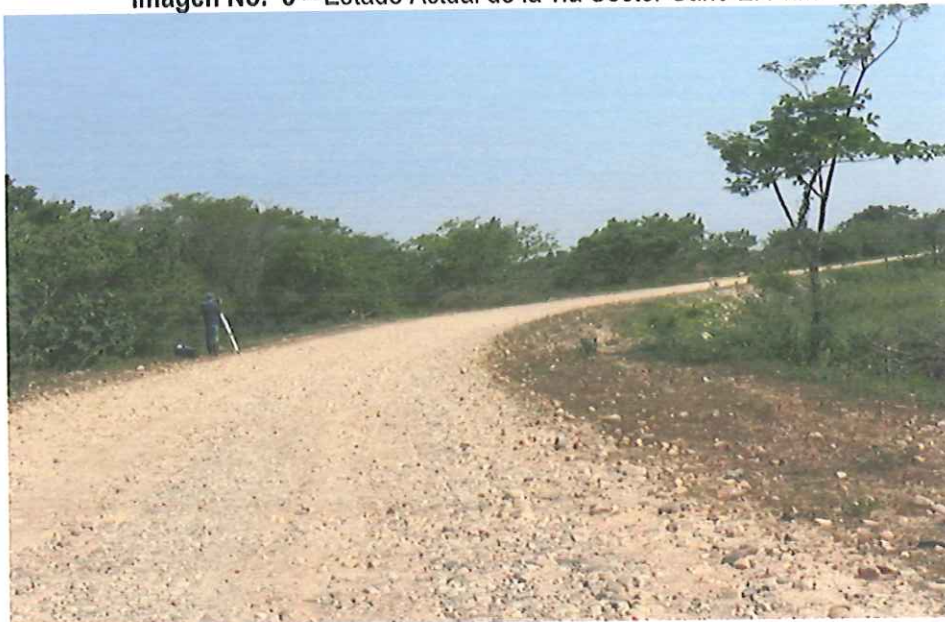
Imagen No. 3 – Estado Actual de la vía Sector Caño El Plato
