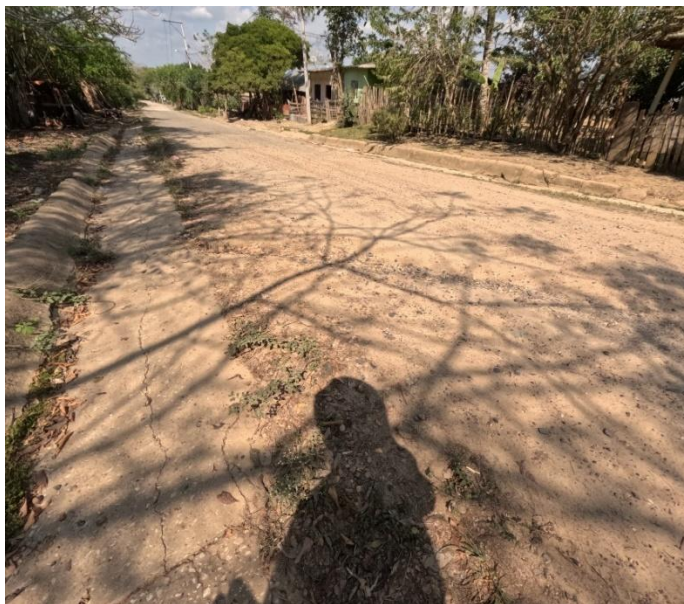
Ilustración 23. Grietas en cunetas desde el K2+810 hasta K2+920
