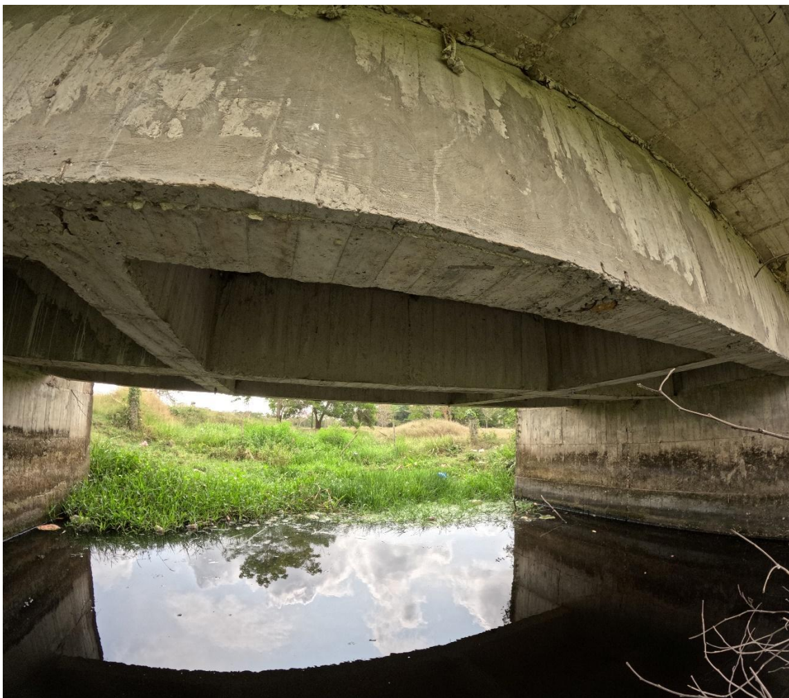
Ilustración 27. Estado actual del puente en K1+550.
