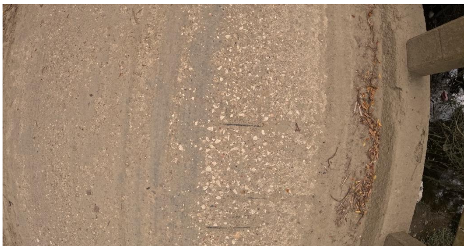
Ilustración 35. Exposición de acero de refuerzo losa y bordillos del puente K3+613
