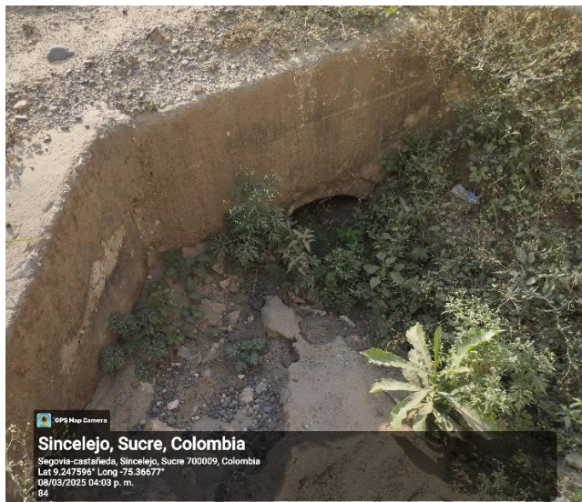
Ilustración 17. Mantenimiento inadecuado. Salida obstruida con sedimentos. Box Culvert K7+315. Fuente Inspección en la vía
