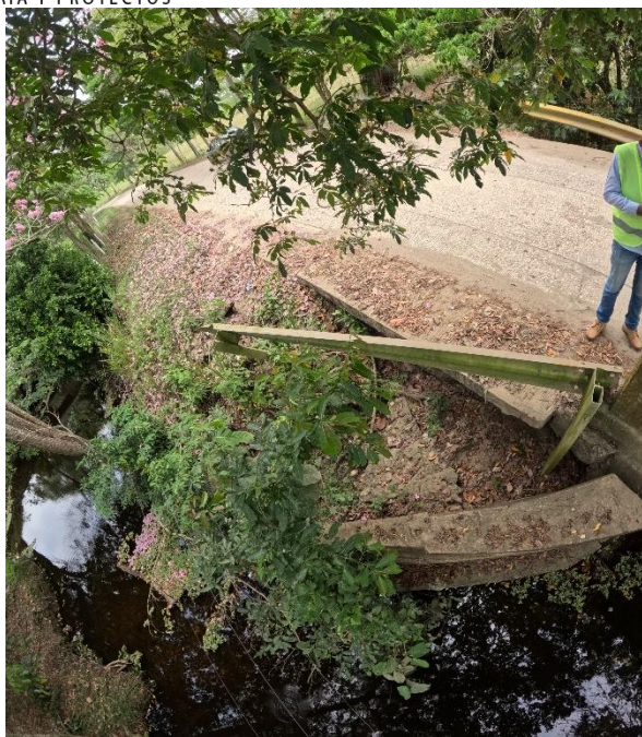
Ilustración 38. Socavación vista aérea entre el puente K3+007 y la placa huella
