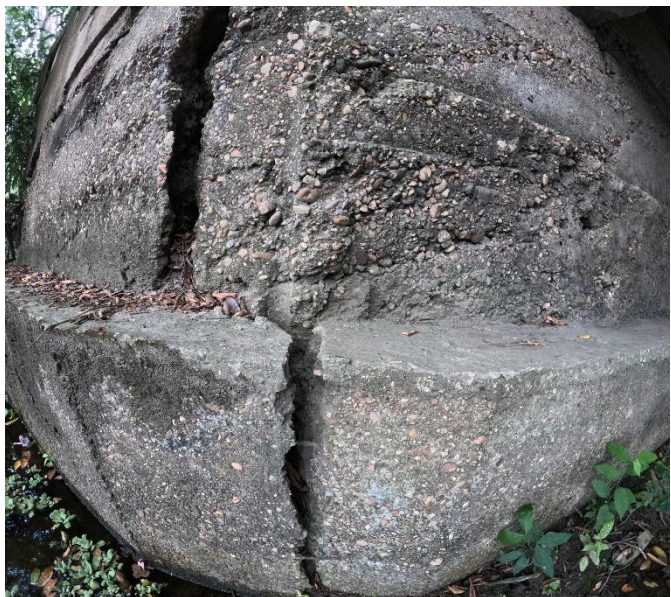
Ilustración 30. Desprendimiento de las aletas y cabezal Puente K3+613. Vista frontal Ancho: 20cm
