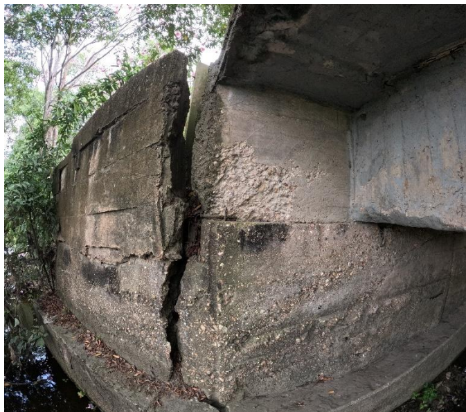
Ilustración 29. Desprendimiento de las aletas Puente K3+613. Vista frontal Ancho: 40cm
