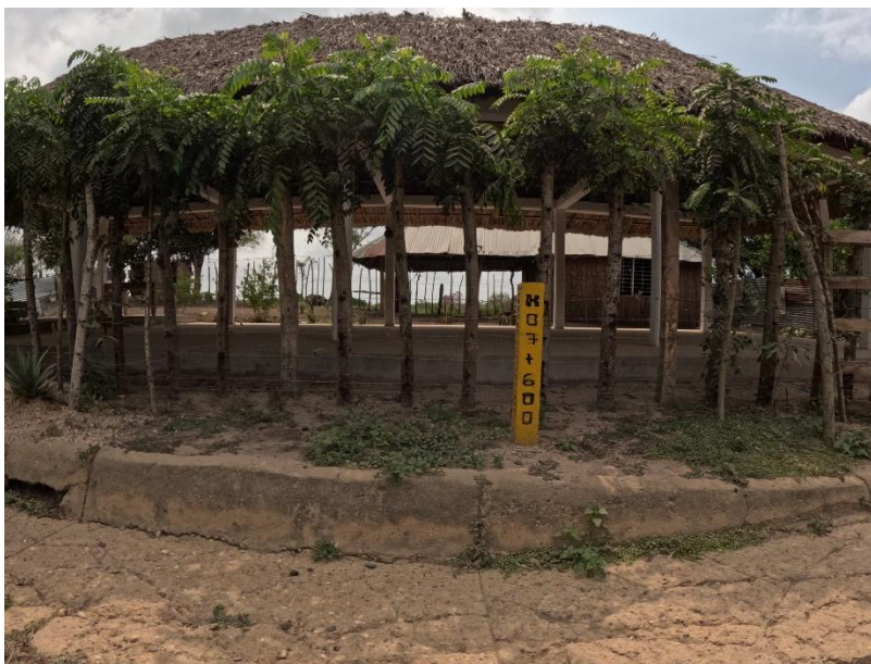
Ilustración 20. Fracturamiento de cunetas en el K2+800
