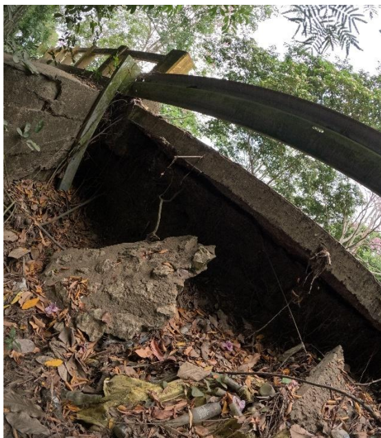
Ilustración 36. Socavación lado derecho entre el puente K3+613 y la placa huella
