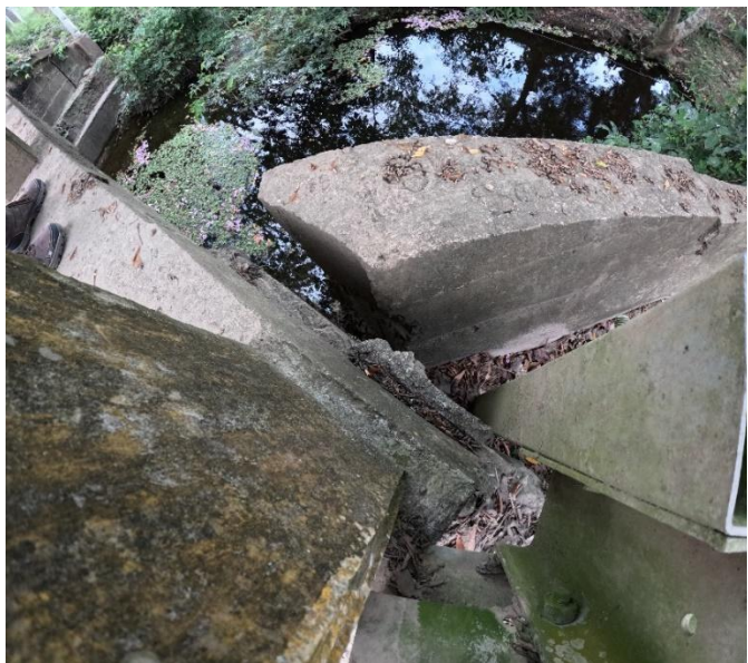
Ilustración 28. Desprendimiento de las aletas Puente K3+613. Vista aérea Ancho: 40cm
