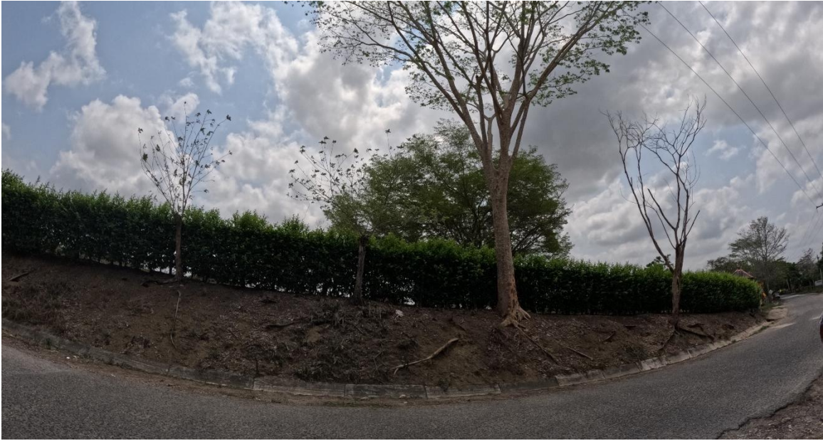
Ilustración 40. Talud K9+950 y el K10+150
