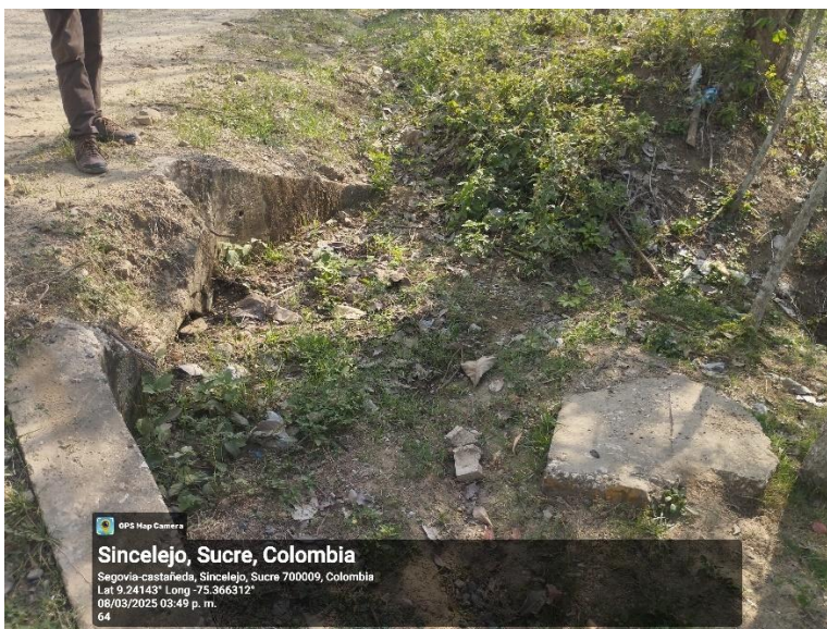
Ilustración 15. Pérdida total del muro Box Culvert K6+427. Fuente Inspección en la vía.
