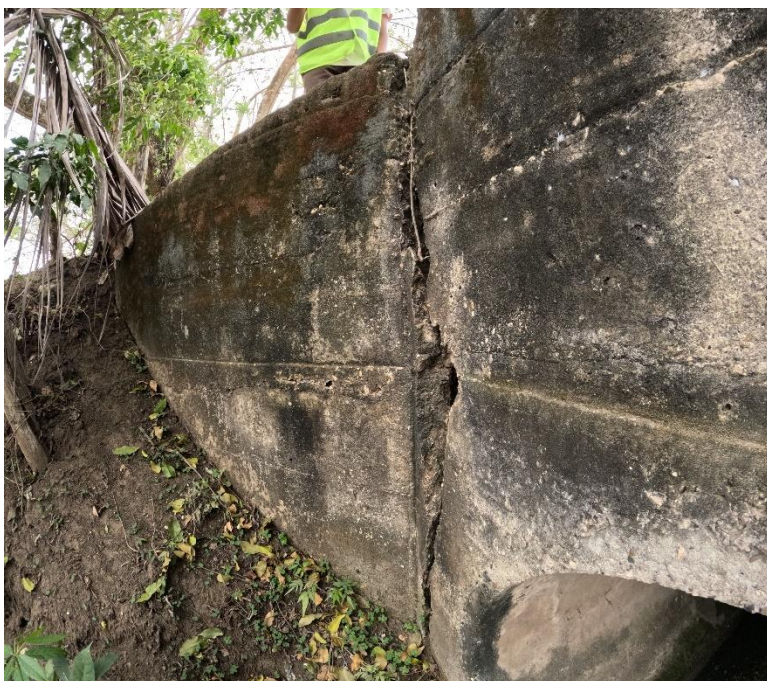
Ilustración 12. Grietas verticales en la unión entre el muro cabezal y las aletas. Alcantarilla sencilla K9+765. Fuente Inspección en la vía.
