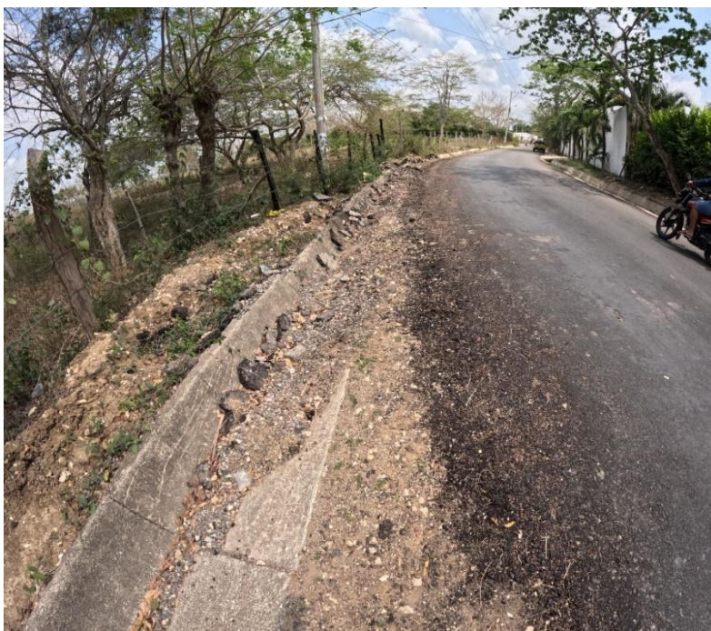
Ilustración 25. Escombros sobre cuneta generan obstrucción. K9+570 hasta K9+800
