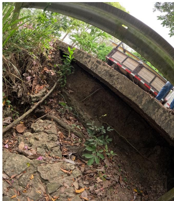
Ilustración 37. Socavación lado izquierdo entre el puente K3+613 y la placa huella
