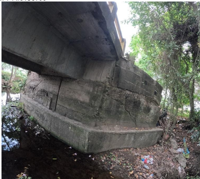
Ilustración 32. Grietas en los muros Puente K3+613. Vista frontal Ancho: 20cm
