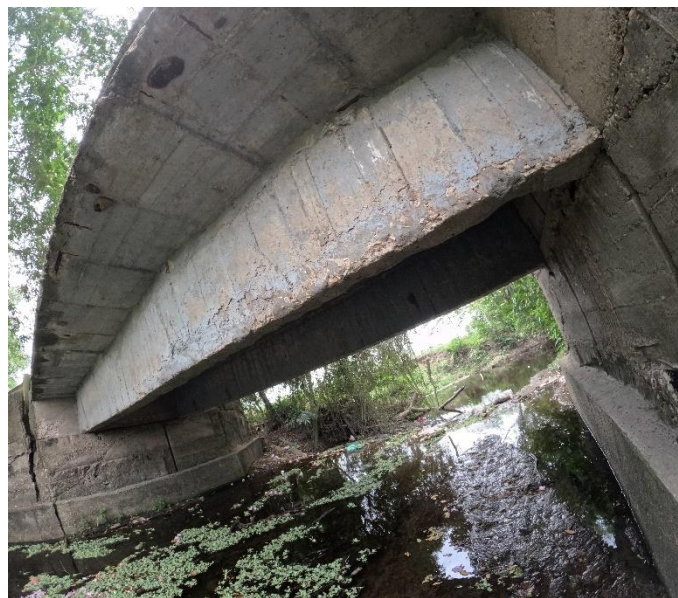
Ilustración 33. Grietas en los muros Puente K3+613. Vista parte baja Ancho: 20cm
