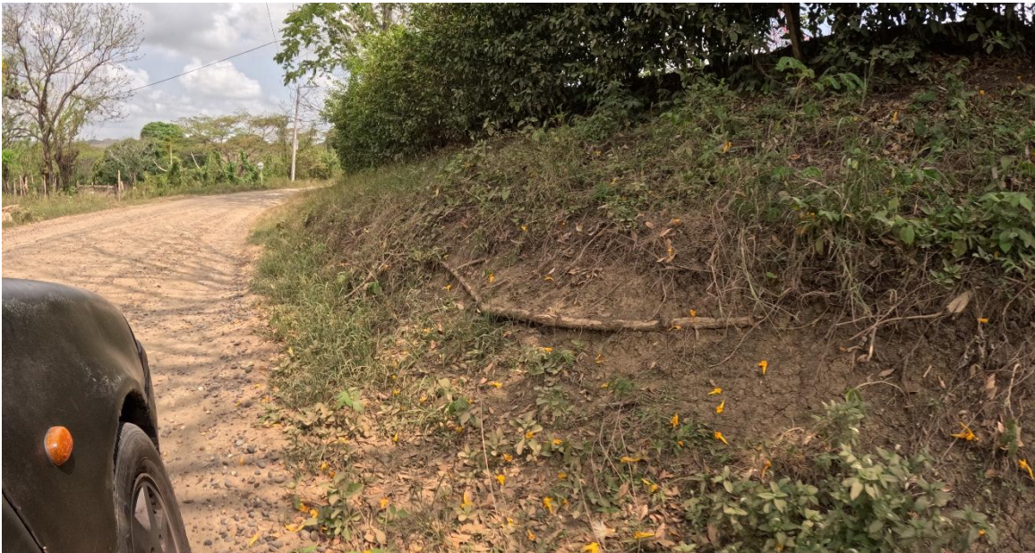
Ilustración 41. Talud entre K5+995 - K6+200
