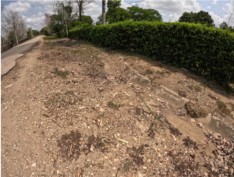
Ilustración 21. Fracturamiento de la estructura en el K9+500
