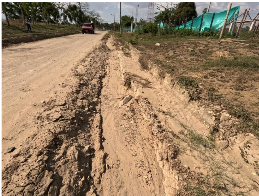
Ilustración 22. Socavación de la vía Cuneta derecha. K2+610 hasta K2+810.
