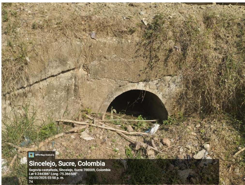
Ilustración 9. Grietas en aletas, muros. Alcantarilla Sencilla. K6+937 Fuente Inspección en la vía
