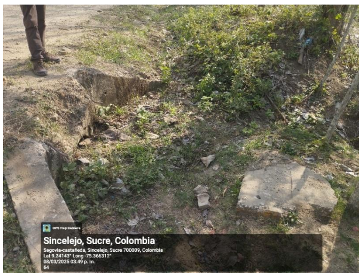
Ilustración 16. Pérdida total del muro box K6+689. Fuente: Inspección en la vía
