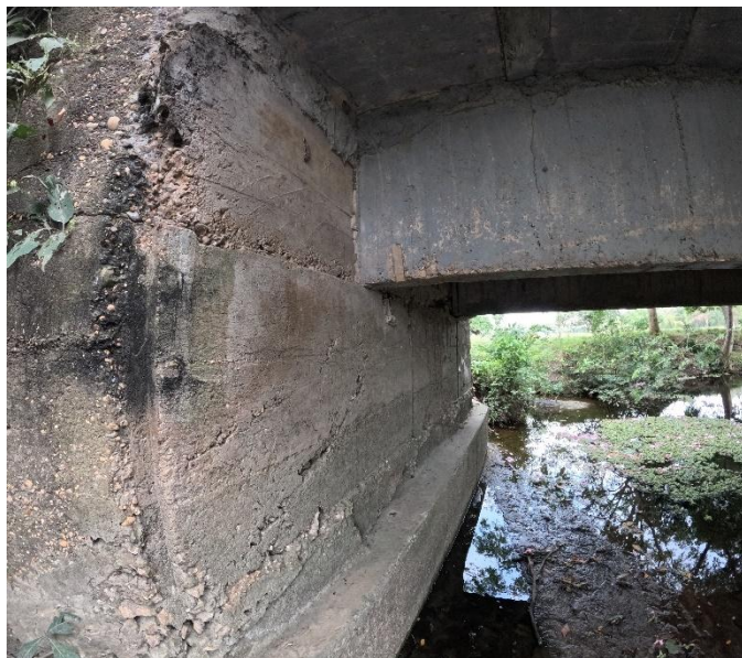
Ilustración 31. Grietas en los muros Puente K3+613. Vista frontal Ancho: 20cm
