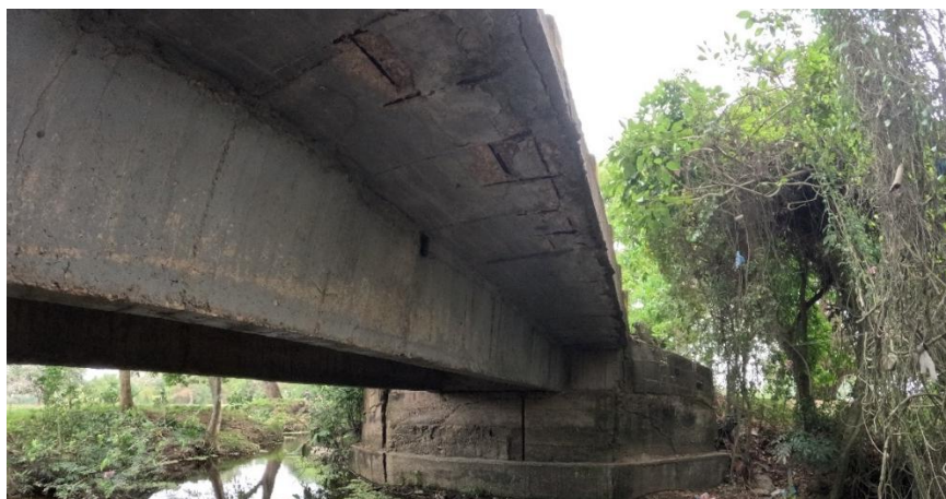
Ilustración 34. Exposición de acero de refuerzo losa del puente K3+613
