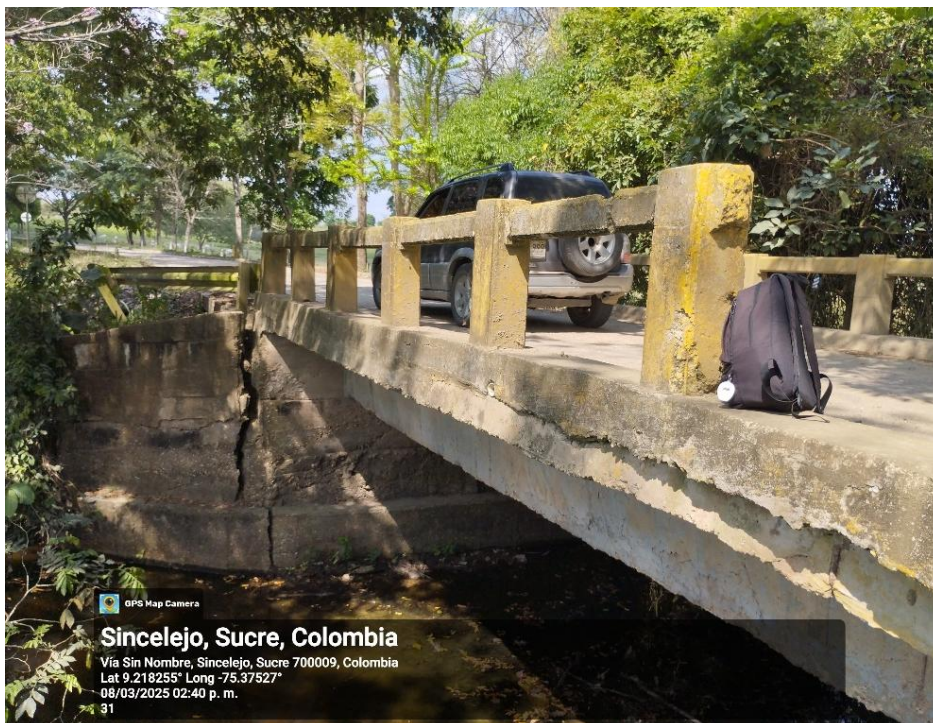
Ilustración 11. Grietas verticales en la unión entre el muro cabezal y las aletas Pontón K3+613. Inspección en la vía.
