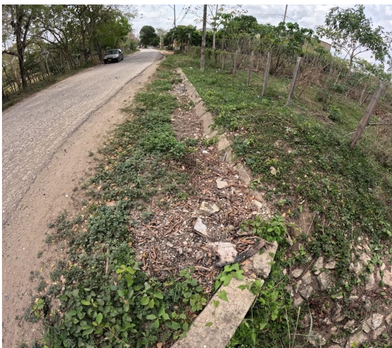
Ilustración 26. Escombros sobre cuenta generan obstrucción en la descarga K9+450 hasta K9+750
