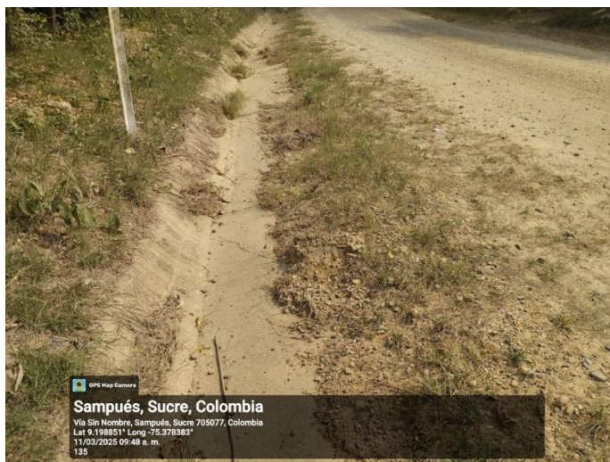
Ilustración 24. Grietas en cuneta izquierda desde K1+195 hasta K1+250
