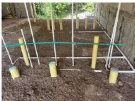
ITEM A3-3.30: Punto de agua fría
