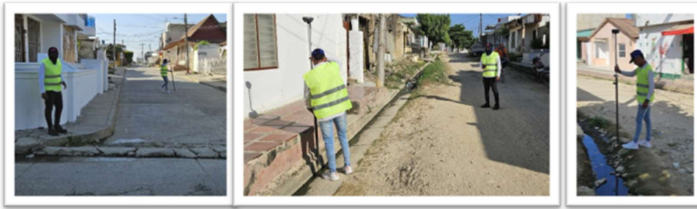
Figura 1. Estado actual de las vías Arjona, Bolívar.
