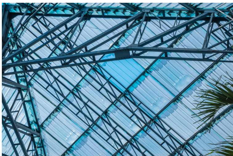
Registro fotográfico afectaciones en cubierta y desgaste pintura de la estructura metálica
