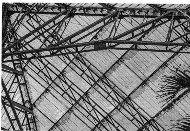
Registro fotográfico afectaciones en cubierta y desgaste pintura de la estructura metálica
