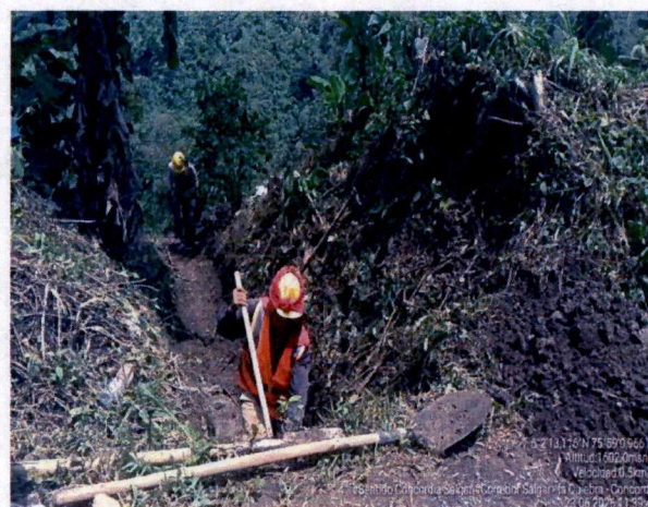
Foto 4. Verificación de personal en el tramo, no se evidencia entrega de dotación
