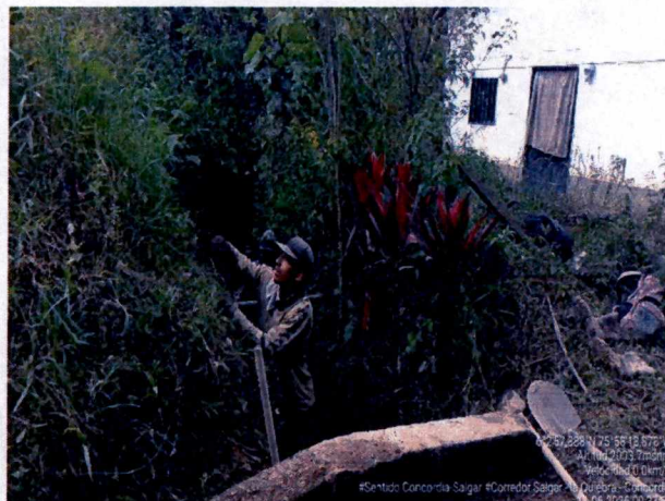
Foto 2. Personal en obra sin sus correspondientes EPP
