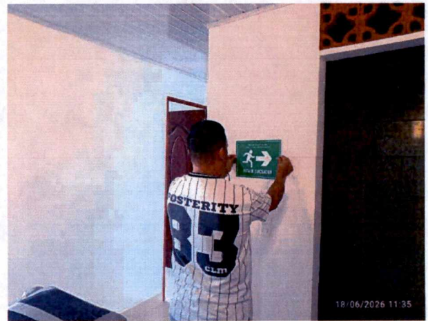
Foto 12. Señalización de rutas de evacuación
