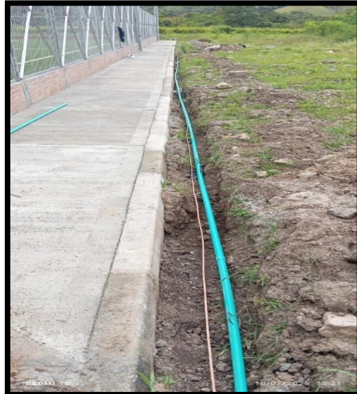
Suministro e Instalación de Acometida en CABLE CU AISL THHN/THWN - 2x8F+1x10T en tubería PVC 1"
