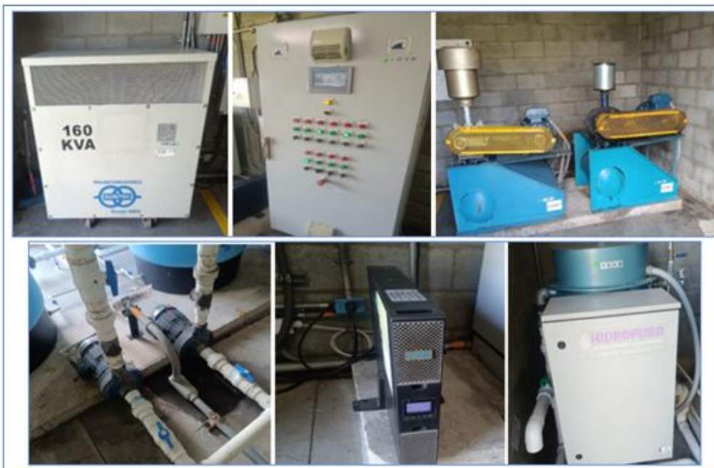
Plantas de tratamiento de agua
