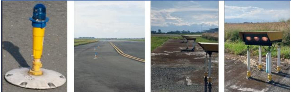
Sistemas de iluminación de pista, luces PAPI
