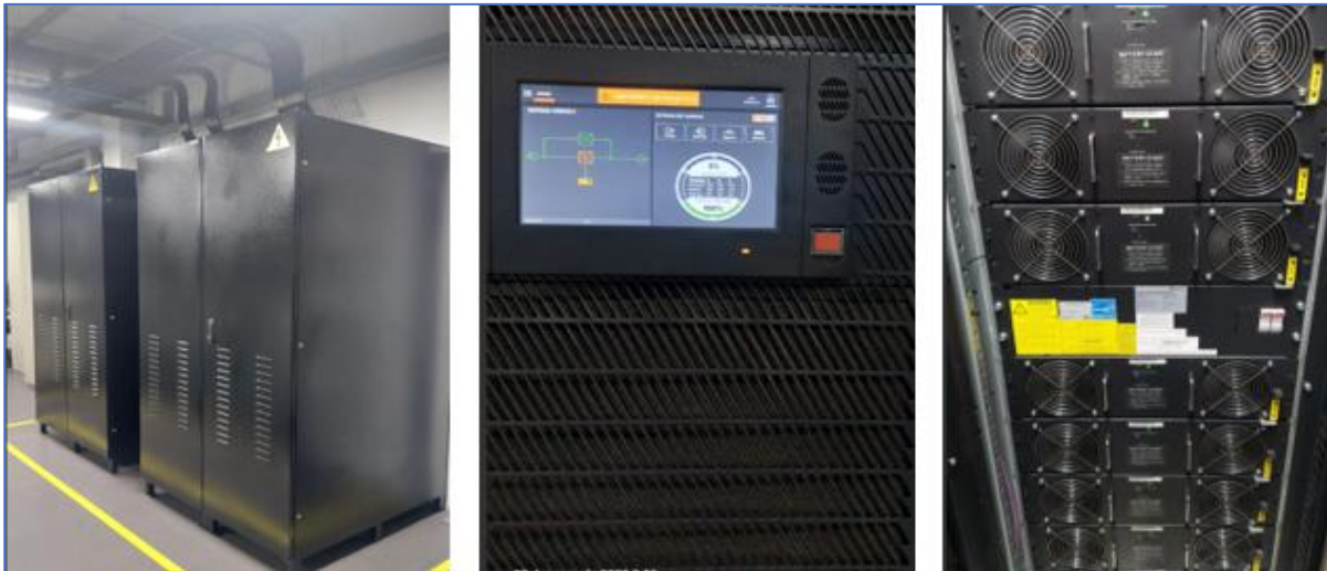
Sistemas ininterrumpidos de potencia (UPS)
