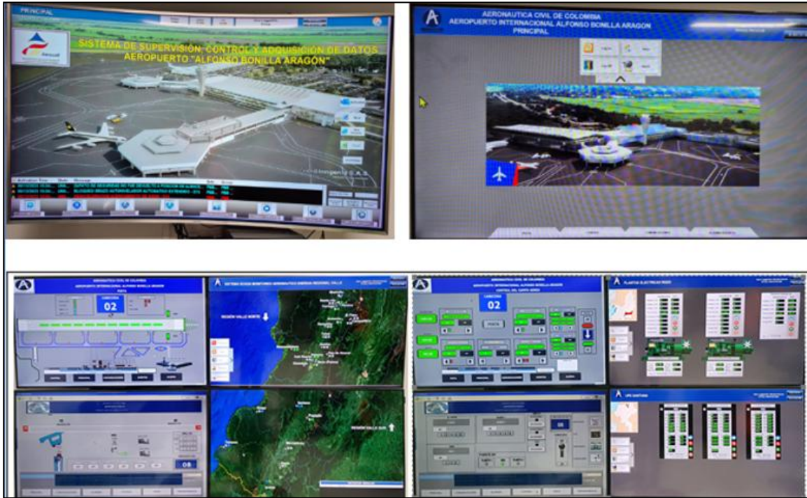
SCDA lado aire y lado tierra.
