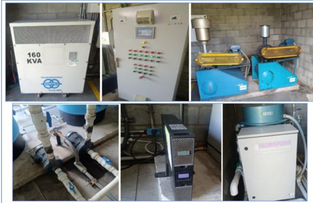
Plantas de tratamiento de agua
