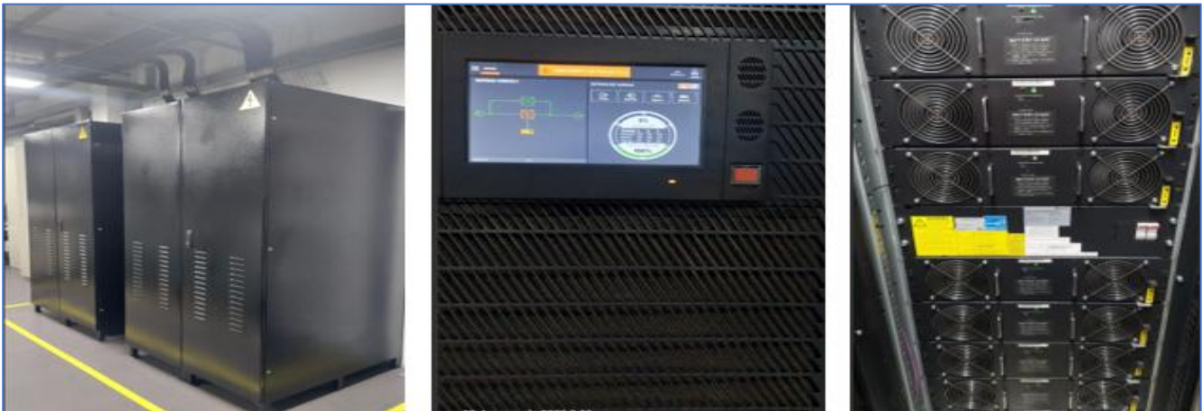
Figura 8. Sistemas ininterrumpidos de potencia (UPS)
