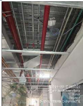
Imagen 7. Red contraincendio Nivel 2
