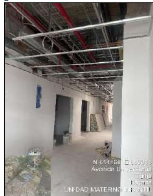
Imagen 8. Red contraincendio Nivel 2
