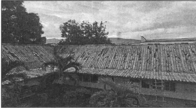
FOTO No 5: Cubierta En Mal Estado
