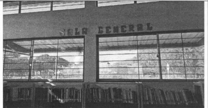
FOTO No 6: Vidrios Rotos En Salón De Biblioteca
