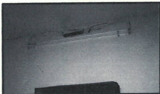
FALTA DE LUMINARIAS
