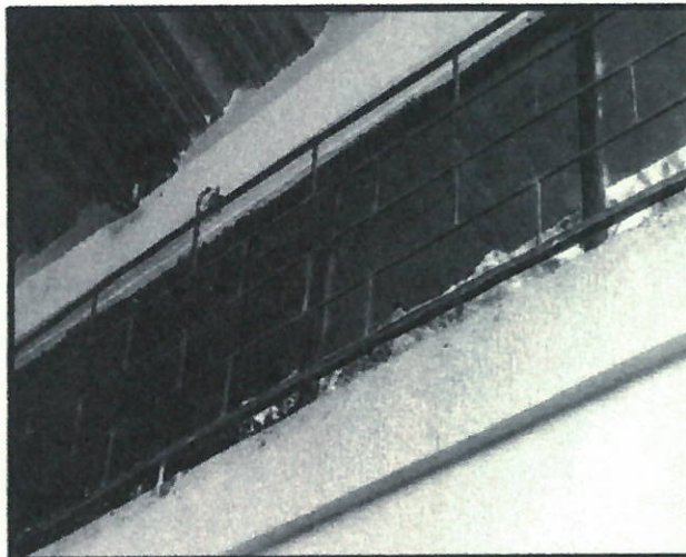
VENTANALES SIN ANGO DE PROTECCION
